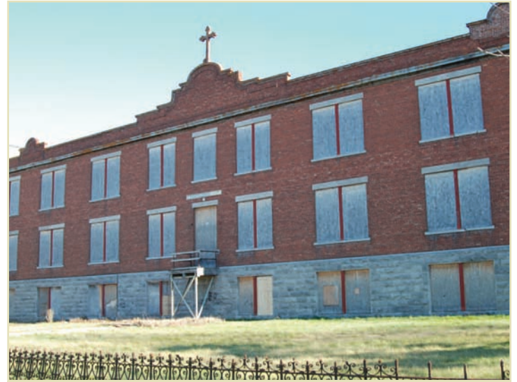
L'école Sainte-Thérèse-d'Avila aujourd'hui désaffectée. Elle porte d'abord le nom d'académie Bélair, puis d'école Sainte-Lucie, avant d'aborder sa dernière dénomination.
