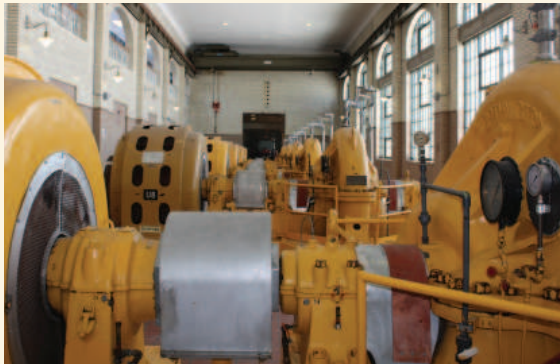
Les pompes de la station de pompage centrale
