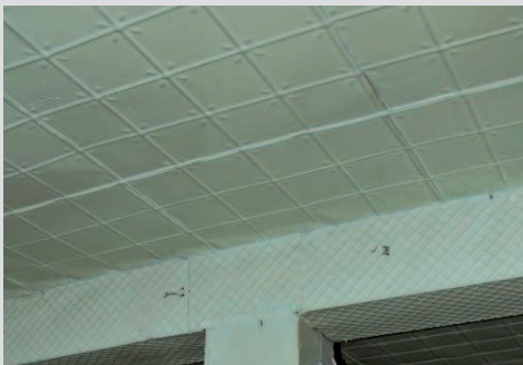
Tôle embossée recouvrant le plafond et les poutres à l'étage (Ville de Montréal, janvier 2012)
