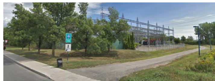
Fig. 21. Emprise d'Hydro-Québec et poste REED (Source: Streetview, Août 2018)
