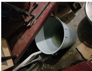
Photo 4 : Fuite d'eau au sous-sol
