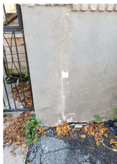
Photo 8 : Fissure dans la fondation (coin)
