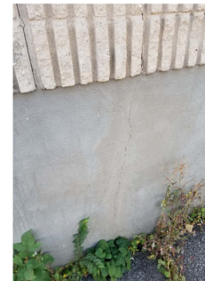
Photo 10 : Fissure dans la fondation
