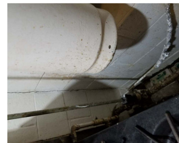
Photo 12 : Fissures dans le bloc intérieur (cuisine)
