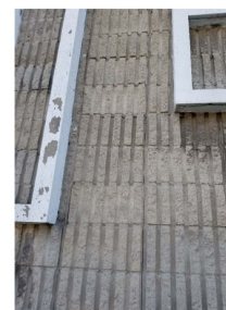
Photo 9 : Fissure dans le parement de blocs
