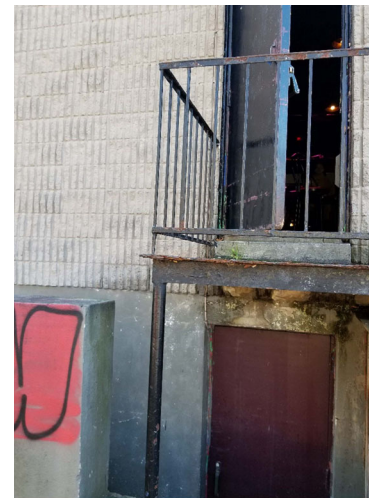
Photo 13: Escalier extérieur endommagé
