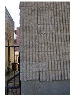
Photo 11 : Fissure dans le mur de blocs
