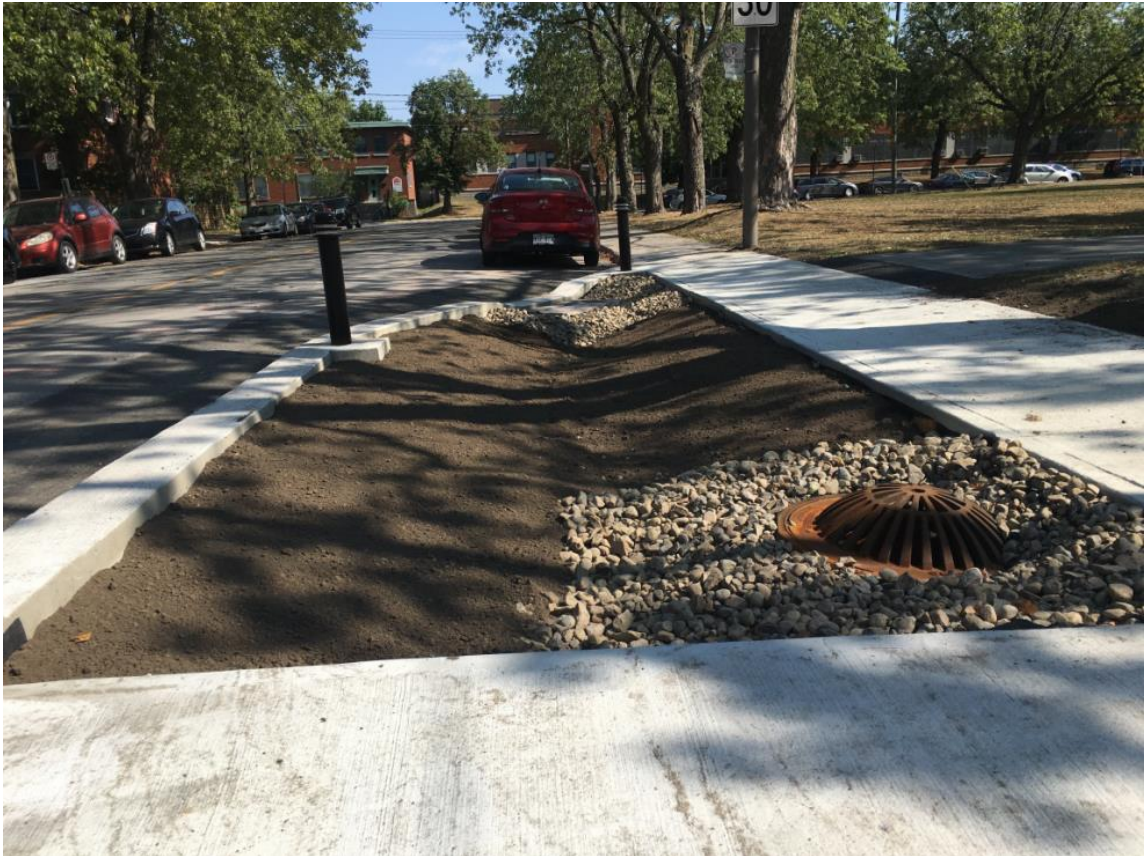
Figure 15 – Puisard de trop-plein avec enrochement pour limiter le dénivelé entre le trottoir et le niveau du fond
