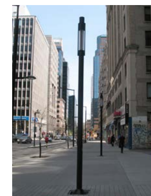
BALISE D'ÉCLAIRAGE : COLONNE LUMINEUSE
