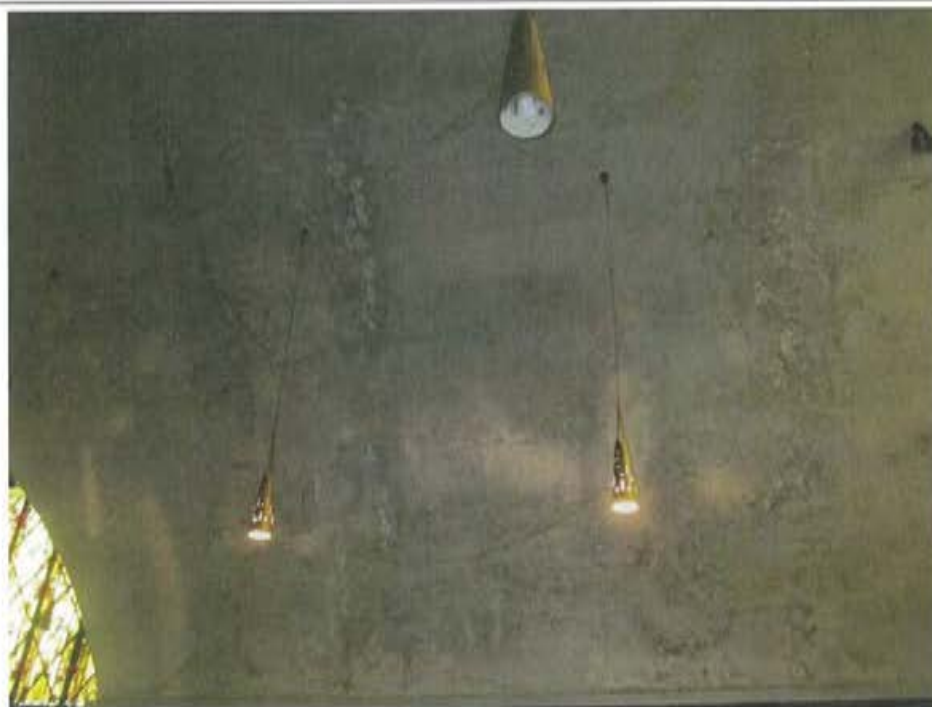
Photo 1 – Nef : croissance de moisissures suspectée sur le produit ignifuge contenant de l'amiante appliqué sur la structure de béton
