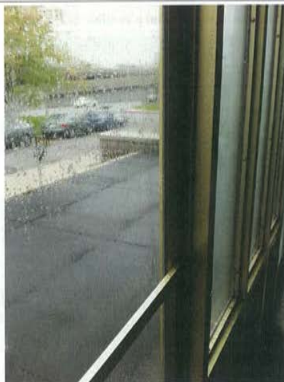
Photo 2 – Narthex : condensation sur les fenêtres et les portes
