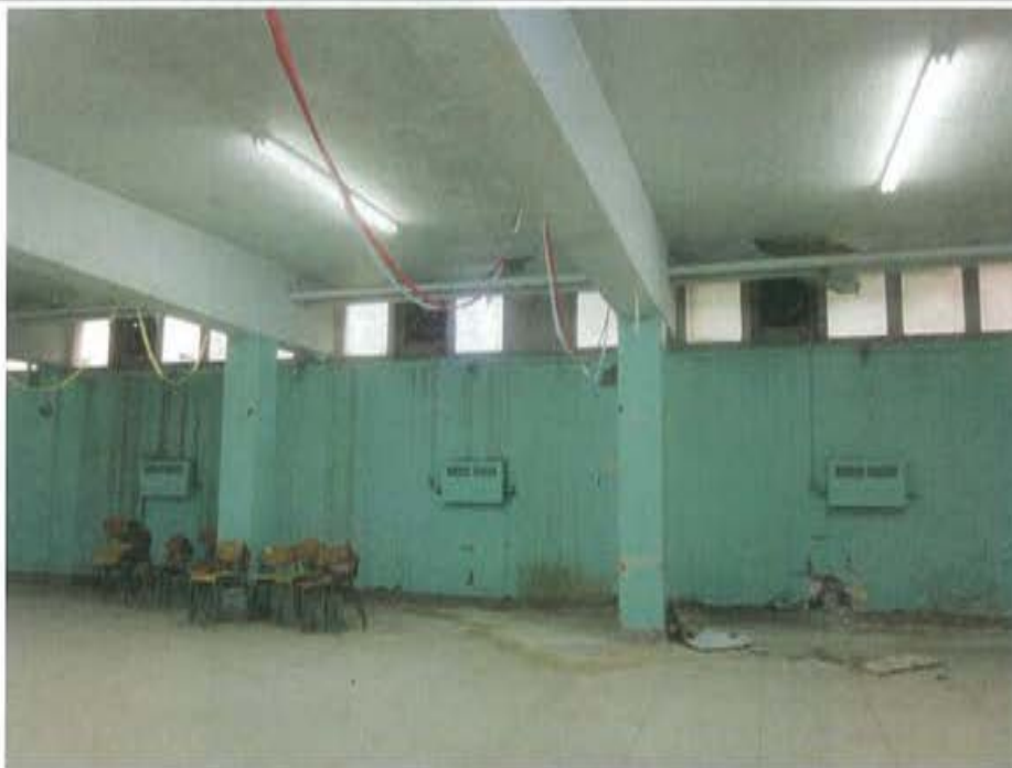
Photo 4 : Sous-sol (partie sud) : coulisses brunes sur les murs périphériques
