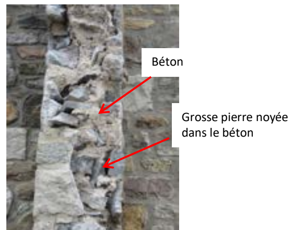
Figure 4 . État d'une aile en 2023 (à 1,50m du sol)
