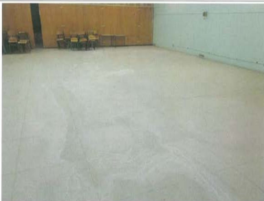
Photo 7 : Sous-sol (partie nord) : efflorescence sur le plancher de la partie basse
