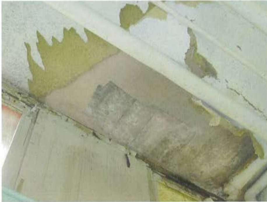
Photo 5 : Sous-sol (partie sud) : produit ignifuge contenant de l'amiante endommagé
