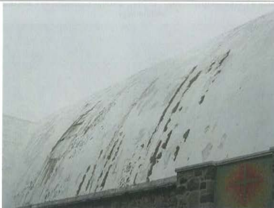
Photo 8 – Extérieur : toiture de béton fissurée et trouée
