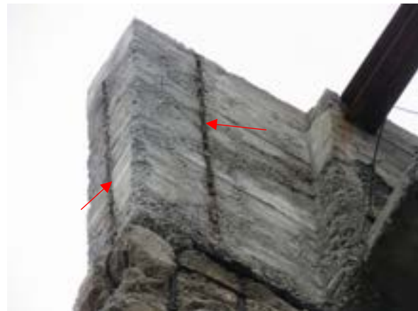
Figure 12. Rainures acier dans la croix en béton armé
