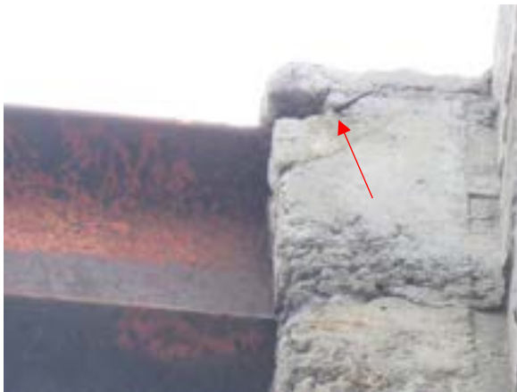
Figure 11. Éclatement du béton au droit de l'ancrage de la structure d'acier
