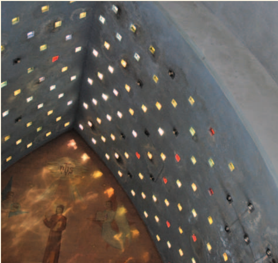
Pavés de verre de la voûte du chœur (Source : Ville de Montréal, juillet 2014)
