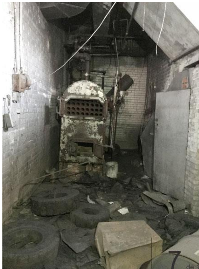
FIGURE 32. Intérieur du bâtiment au rez-de-chaussée, dans la partie qui servait autrefois de garage. Source : STM.
