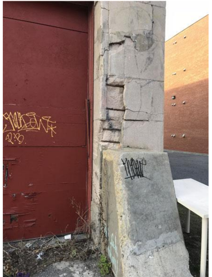
FIGURE 29. La pierre reconstituée en béton moulé est abîmée en façade principale, laissant apparaître son armature en béton. Le massif en béton situé à l'entrée de l'ancien passage servait de chasse-roue. Source : STM.
