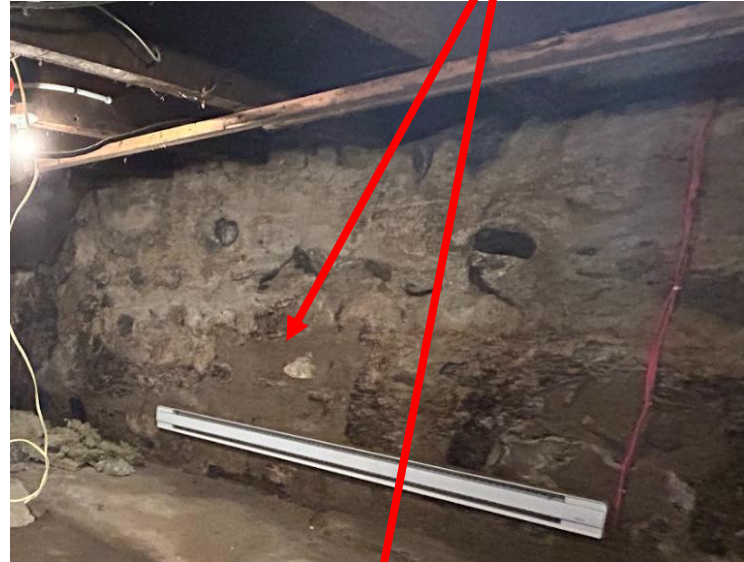
Les murs sont en état d'effritement
