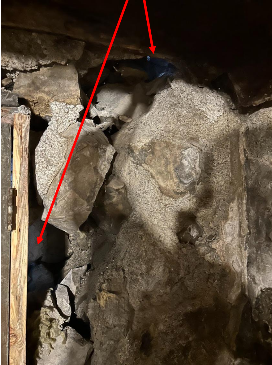
Trous dans la foundation, extérieur visible
