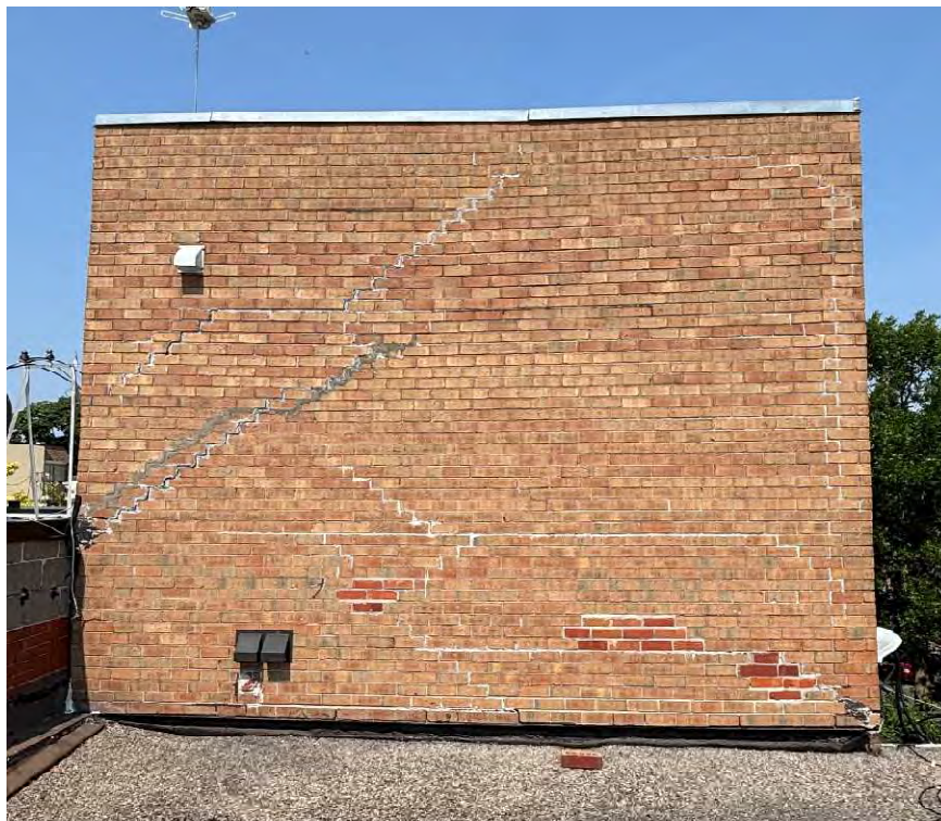
Mur de briques dans un état non sécuritaire qui menace de s'effondrer
