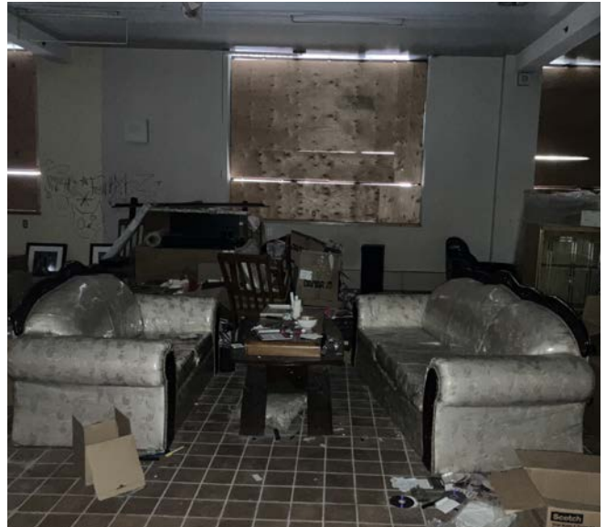
60. MOBILIER ET DÉBRIS AU REZ-DE-CHAUSSÉE, 2025 (VILLE DE MONTRÉAL)
