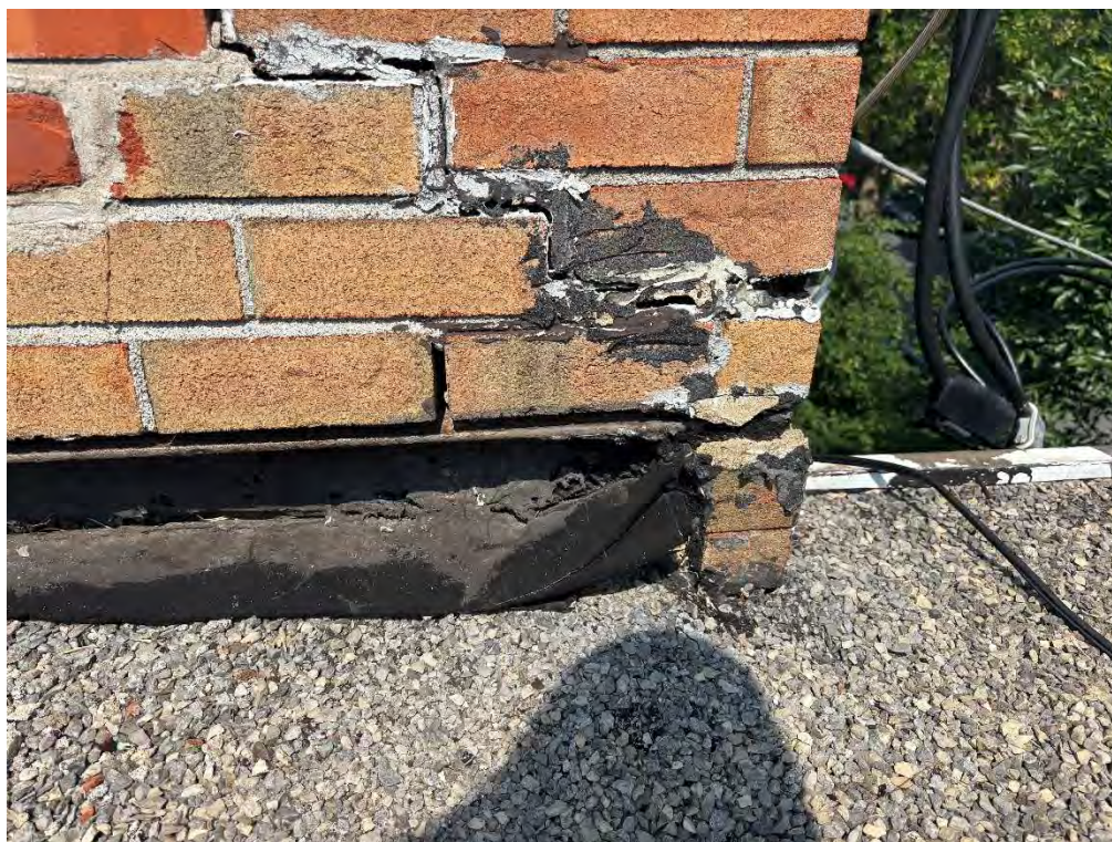
Coin du mur de briques se détachant de l'ossature
