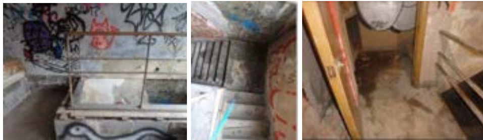
Photos 9 à 10. Escalier desservant la mezzanine débouchant sur l'escalier d'issue 2
