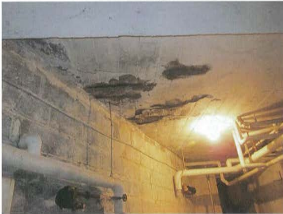
Photo 6 : Sous-sol (local sud-est) : efflorescence sur les murs et le plafond
