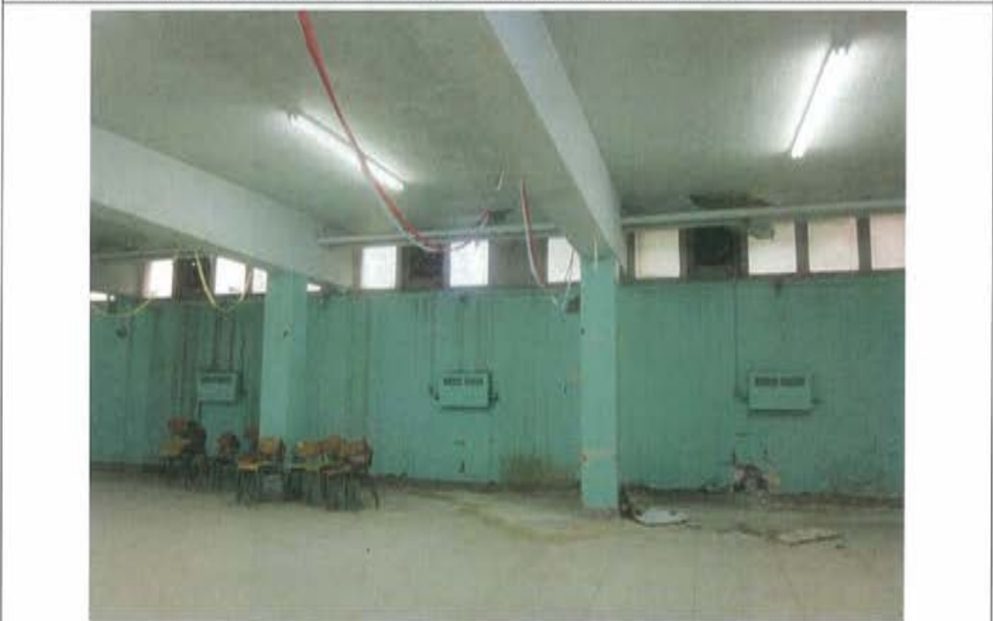
Photo 4 : Sous-sol (partie sud) : coulisses brunes sur les murs périphériques
