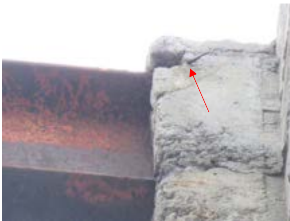
Figure 11. Éclatement du béton au droit de l'ancrage de la structure d'acier
