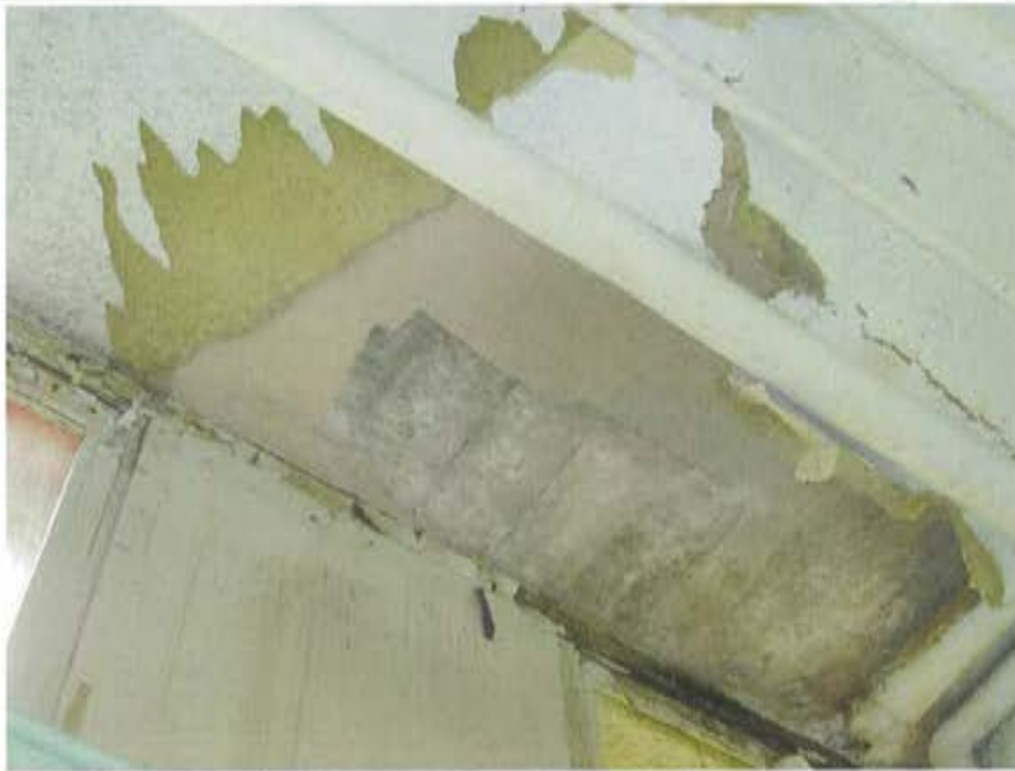
Photo 5 : Sous-sol (partie sud) : produit ignifuge contenant de l'amiante endommagé
