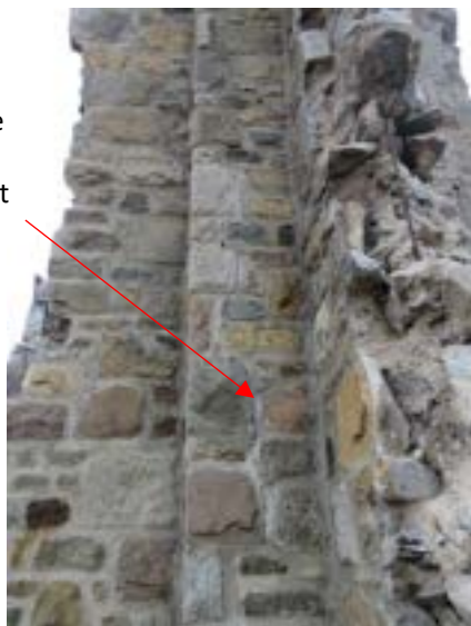
Figure 6. Fissure dans l'ossature du puits d'accès au clocher
