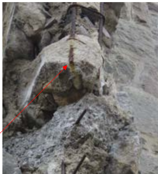
Figure 7. Barre d'armature rompue sur une aile du clocher
