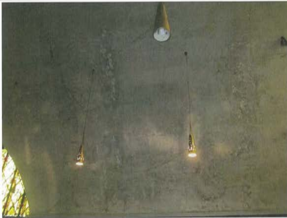
Photo 1 – Nef : croissance de moisissures suspectée sur le produit ignifuge contenant de l'amiante appliqué sur la structure de béton
