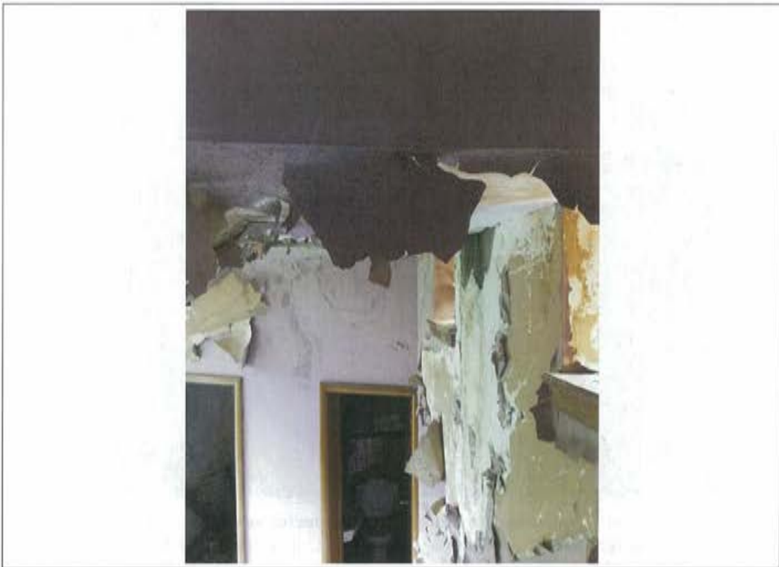
Photo 3 – Cage d’escalier sud-est : peinture écaillée et taches noires sur les surfaces
