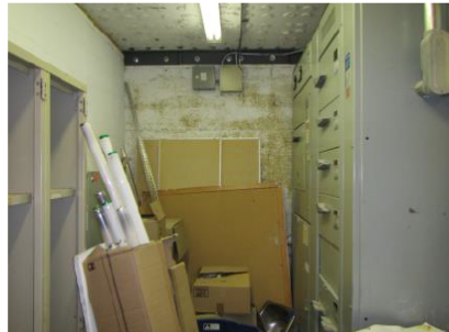
Entreposage divers devant l'équipement électrique – Sous-sol
