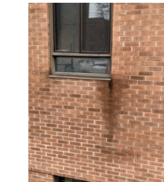
Vue d'un cerne d'eau et de saleté typique sous l'allège (drainage inadéquat)
