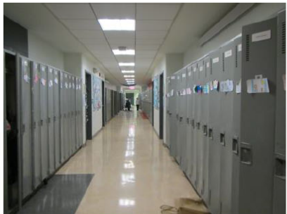
Luminaire typique fixé au plafond dans les couloirs du bâtiment
