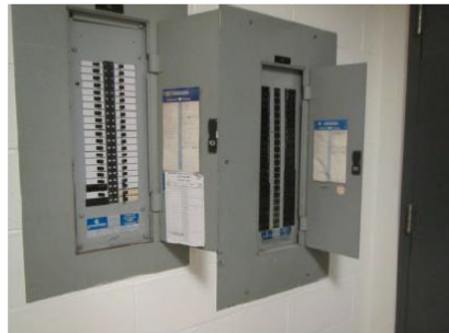
Vue de panneaux électriques typiques sur les étages
