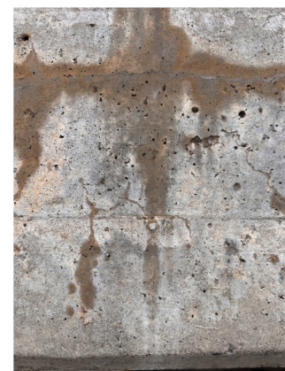
texture du béton
