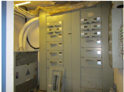
Panneau électrique principal - salle électrique principale située au sous-sol
