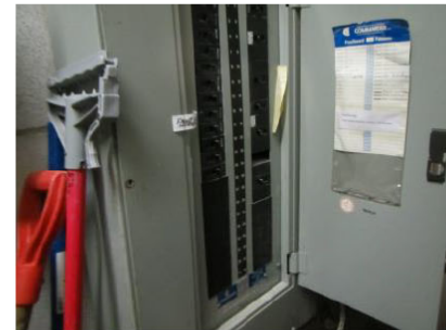
Ouverture typique constatée dans un panneau électrique
