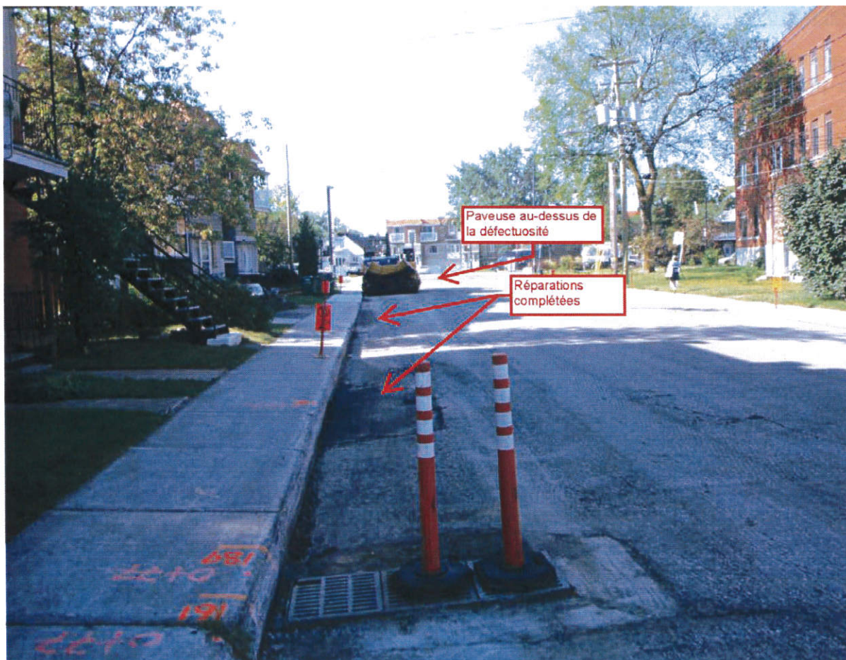
Photo provenant du surveillant de SNC-Lavalin montrant qu'une paveuse de l'entrepreneur Demix était stationnée directement au-dessus de la défectuosité montrée sur la photo 1 du rapport du BIG.
