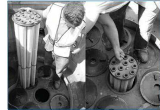
Figure 6 : Cartouche de filtration : installation
