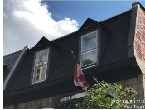
Travaux sans permis, photo 2021-08-30
