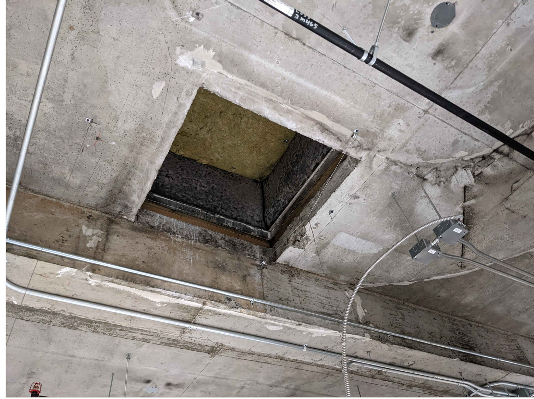
PHOTO #4 - OUVERTURE TYPE DANS LA SALLE MÉCANIQUE (CONDUIT RETOUR)
