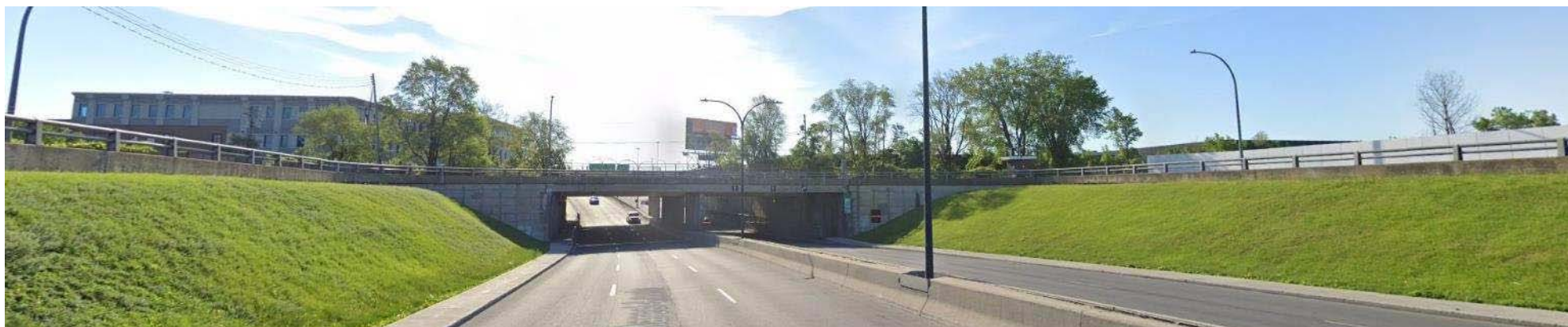
Structure du tournebride Nord, vue depuis le boul. Marcel-Laurin, en direction Sud
