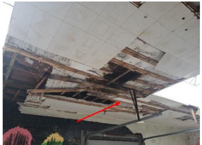
FIGURE 37 Plafond de l'aire ouverte à l'étage qui démontre l'état de dégradation de l'immeuble soumis à des infiltrations d'eau et aux squatteurs. Source : STM.
