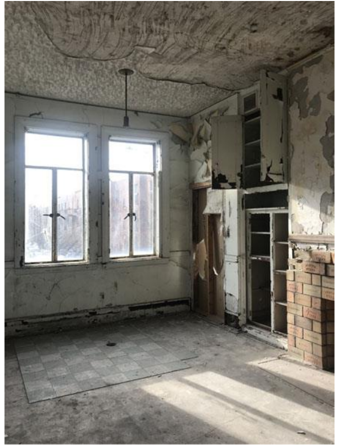
FIGURE 36 . Le bureau principal de l'étage se situant dans l'angle sud-est du bâtiment. Ce bureau comprenait un foyer, ce qui indique qu'il s'agissait probablement du bureau du président de l'entreprise. Source : STM.
