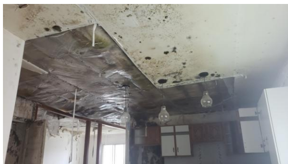
i. fuite d'eau
