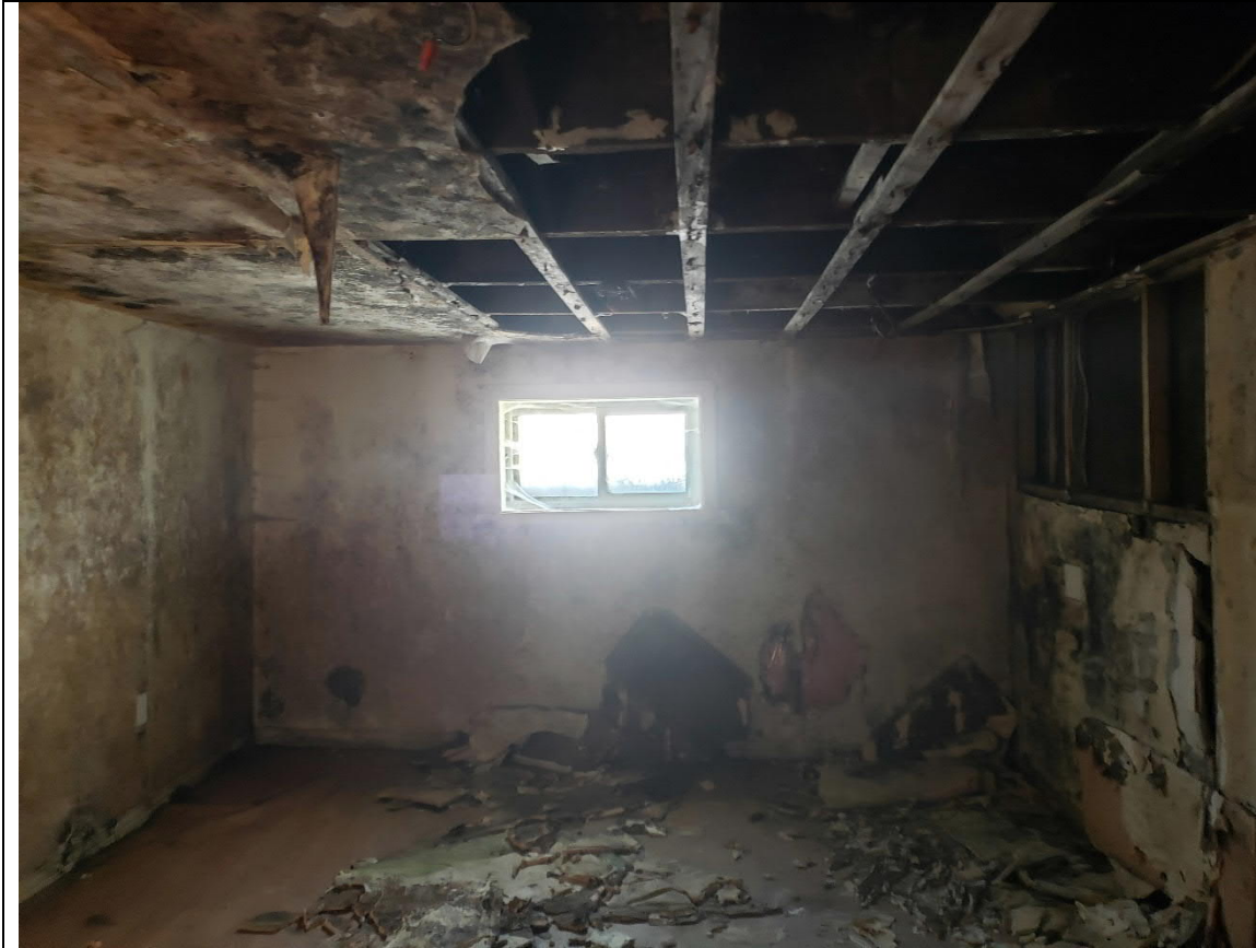
Photo 1 : État du sous-sol et des fondations
