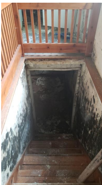
ii. moisissure dans l'escalier
