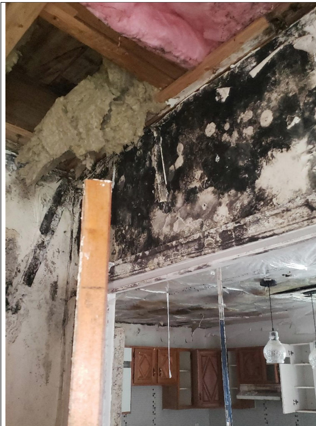
Photo 4 : État du rez-de-chaussée et du plafond
