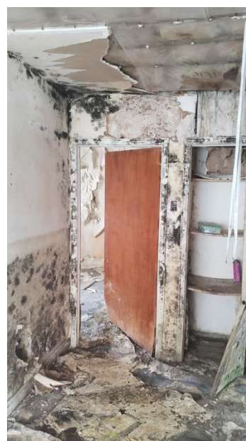
iii. infestation de moisissure
