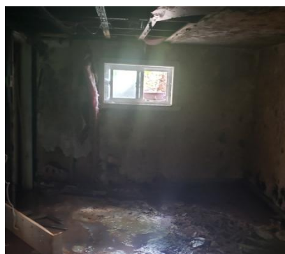
iv. infiltration majeure d'eau
