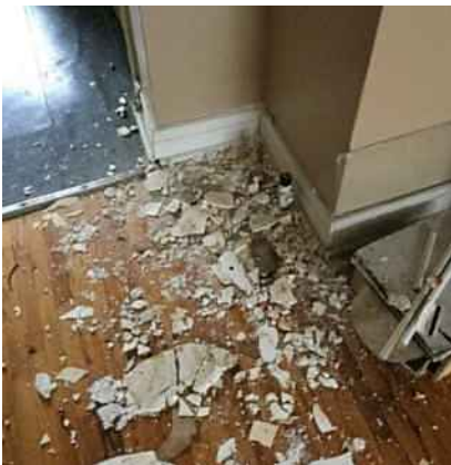
Signes de démolition ponctuelle
