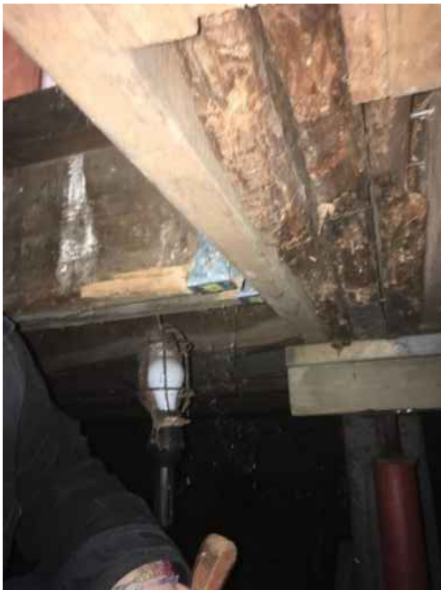
Photo 1 : Jackpost ajouté pour supporter les solives maitresses. Solives maitresses endommagées
