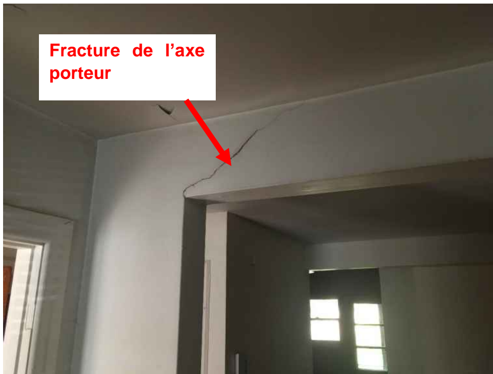
Photo 2 : Fracture au plafond indiquant le tassement des fondations existantes
