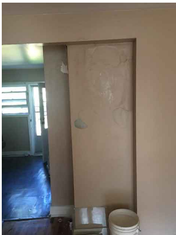
Photo 8 : infiltration d'eau autour de la cheminée
