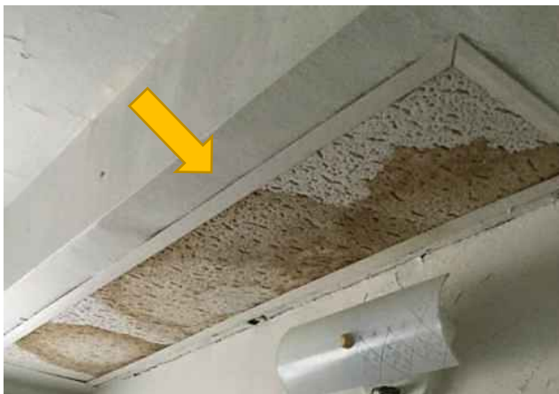
Infiltration d'eau dans le plafond
