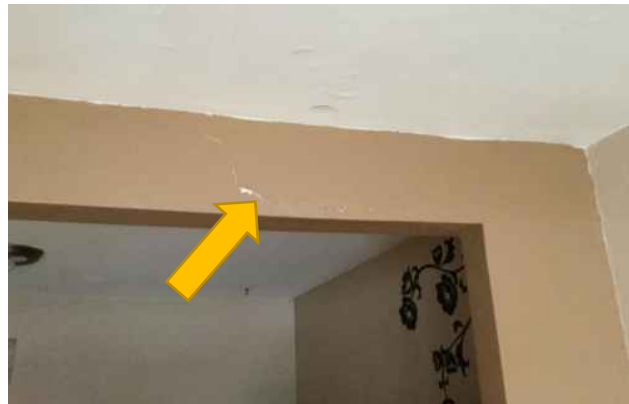
Arche potentiellement porteuse fissurée
