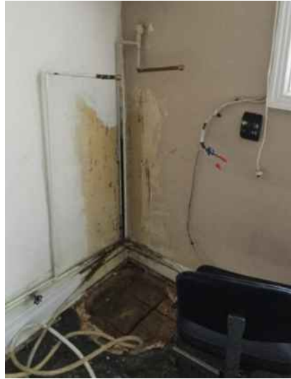
Moisissure au sol et mur
