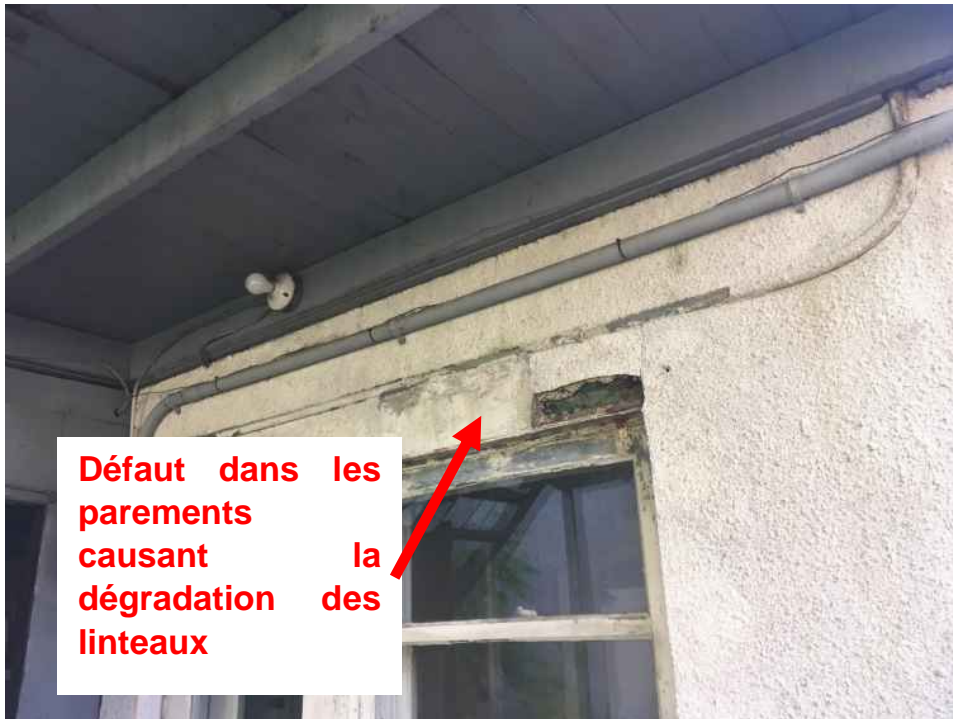
Photo 6 : linteau à sécuriser et remplacer sur la façade arrière
