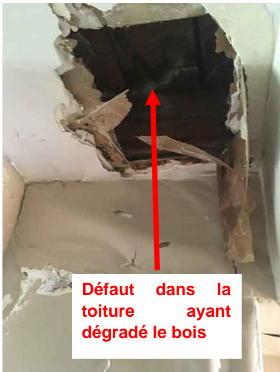
Photo 7 : structure autour de la cheminée à sécuriser d'ici aux travaux
