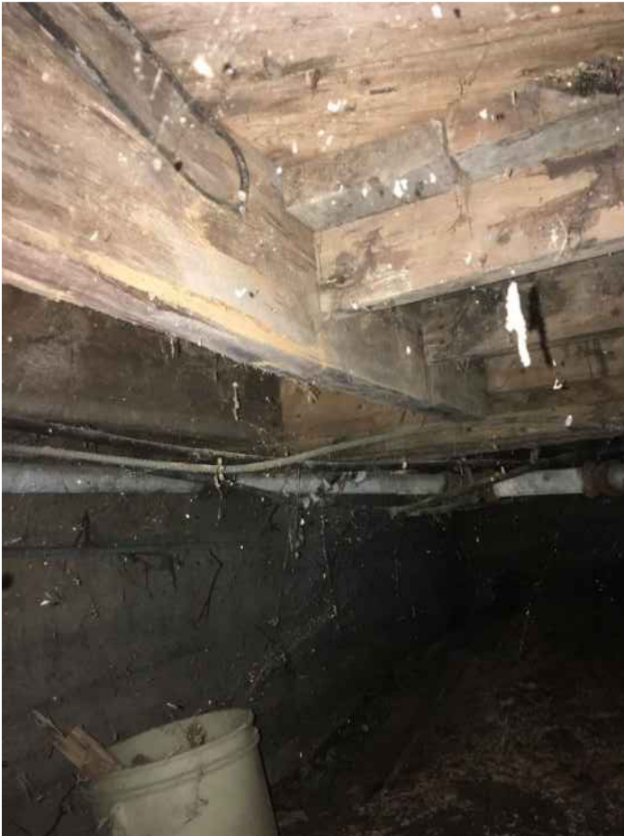
Photo 5 : plancher du RDC à sécuriser et remplacer
