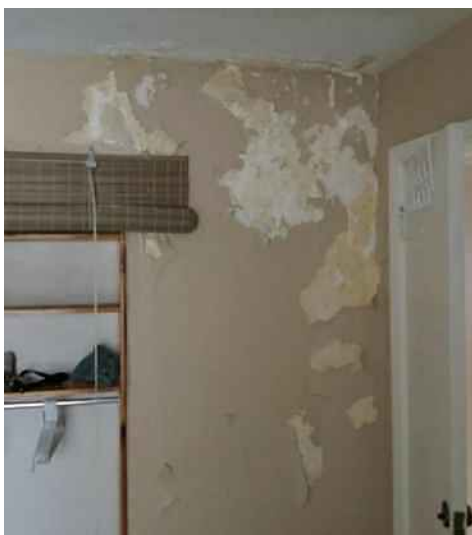
Murs en mauvaises conditions
