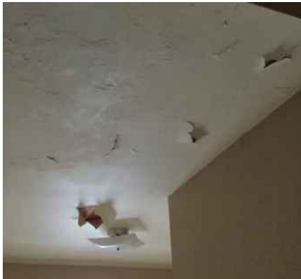
Plafond en mauvaise condition
