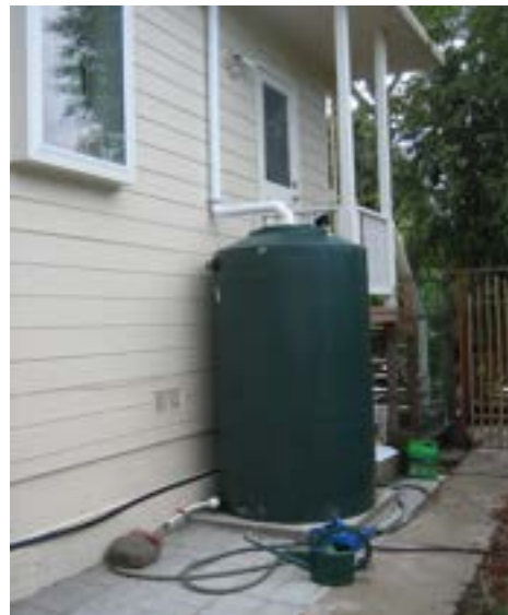
Fig. 274. Baril d'eau de pluie sur le domaine privé (Source: Grey Water Action)
