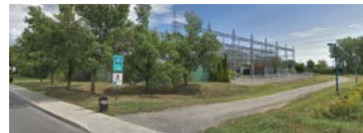
Fig. 90. Emprise d'Hydro-Québec et poste REED (Source: Streetview, Août 2018)
