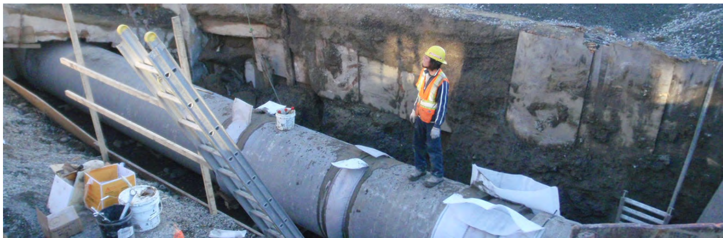
Remplacement d'une conduite primaire sur Pie-XI suite à un bris en octobre 2015
