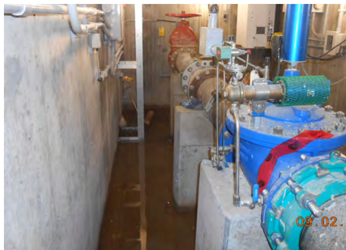
Exemple de nouvelle chambre de régulation de pression
