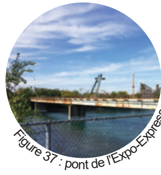
I- Pont de l'Expo-Express Date : 1967 État : dangereux
