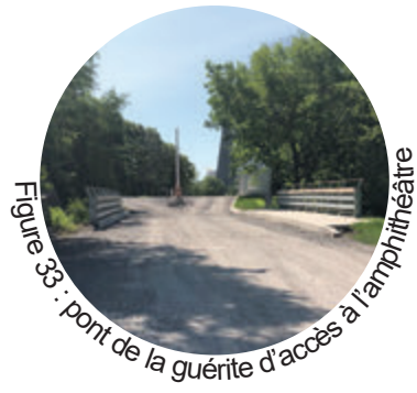
E- Pont de la guérite d'accès à l'amphithéâtre État : excellent
