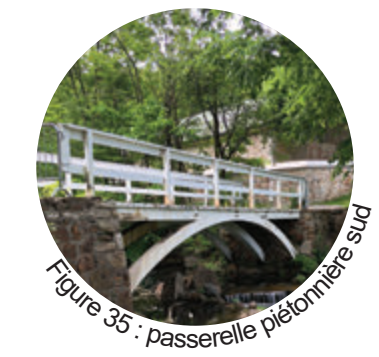
G- Passerelle piétonnière sud 1967 État : dangereux
