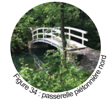
F- Passerelle piétonnière nord 1967 État : dangereux
