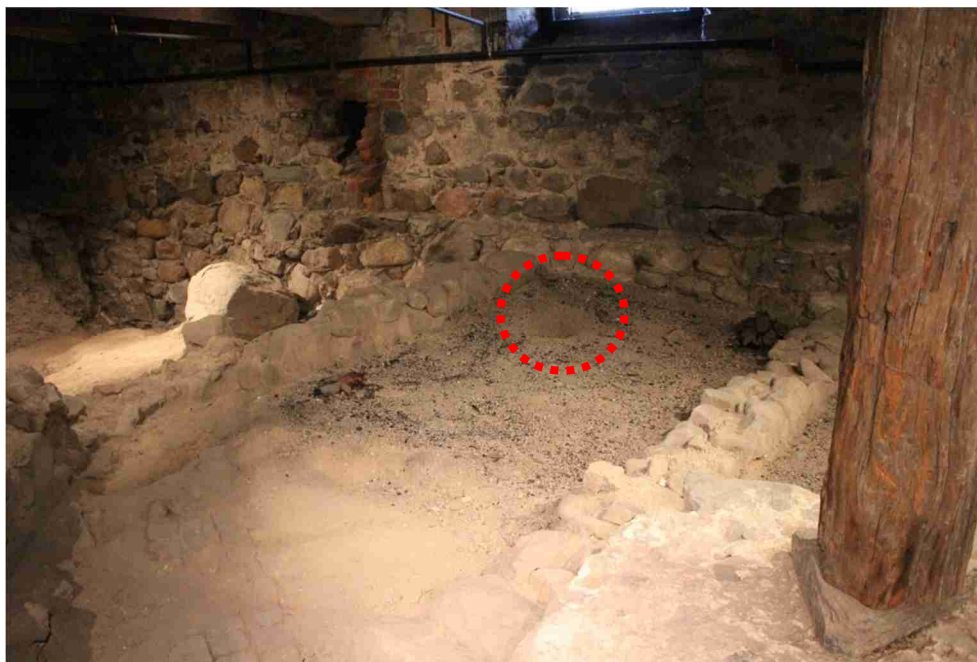
Figure 5 : Photographie de la zone d'affaissement
