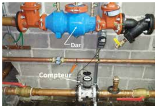
Exemple d'un compteur installé avec un dispositif anti-retour
