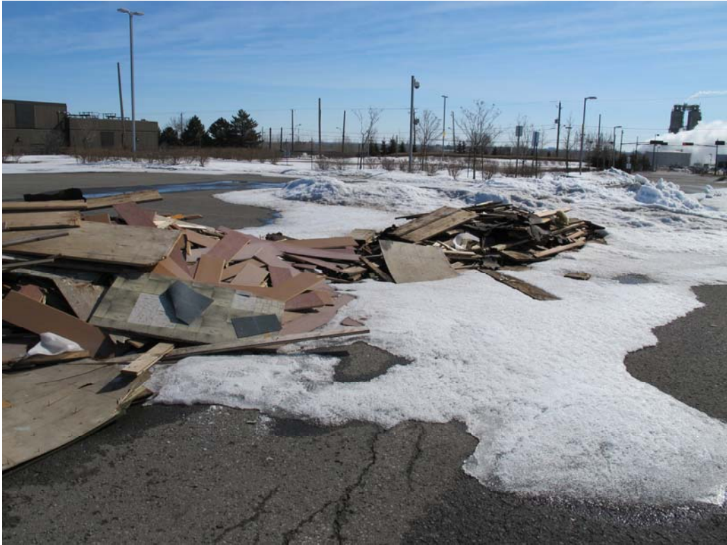
Débris de démolition et stationnement (vue vers le sud-est)
