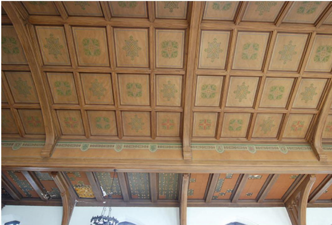
Détail de la fausse-voûte avec ses caissons, consoles, ailerons, membrures et motifs peints au pochoir.
