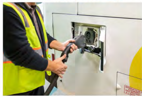
Exemple de branchement pour recharge
