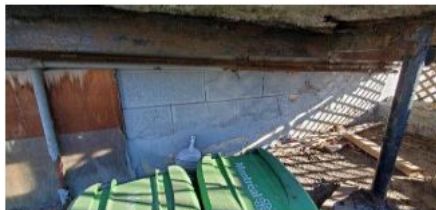
Photo 23- fissures bloc de béton
