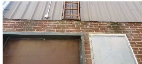
Photo 5- fissures revêtements briques
