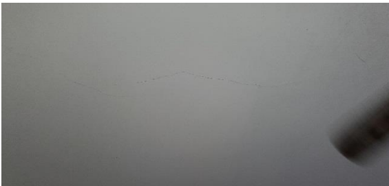
Photo 42 – Fissures et gonflement plafond 2 e étage
