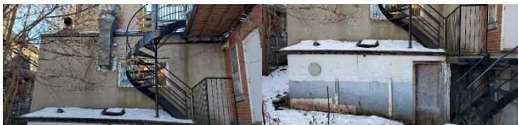
Photo 25- fissures bloc de béton
