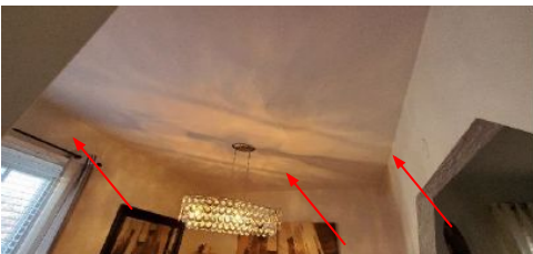
Photo 40 – Fissures et gonflement plafond 2 e étage
