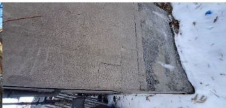
Photo 22- fissures bloc de béton
