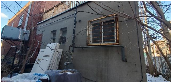
Photo 21- fissures bloc de béton
