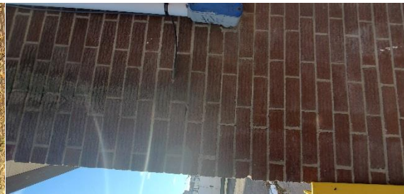
Photo 4- fissures revêtements briques
