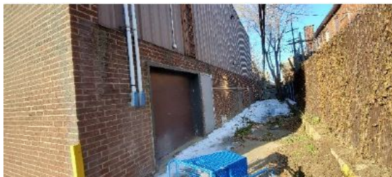
Photo 3- fissures revêtements briques
