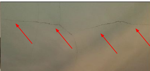
Photo 41 – Fissures et gonflement plafond 2 e étage
