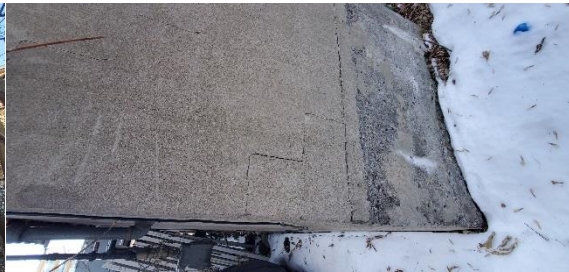
Photo 22- fissures bloc de béton
