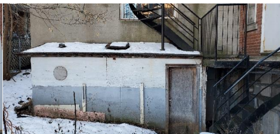
Photo 26- fissures bloc de béton
