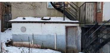
Photo 26- fissures bloc de béton
