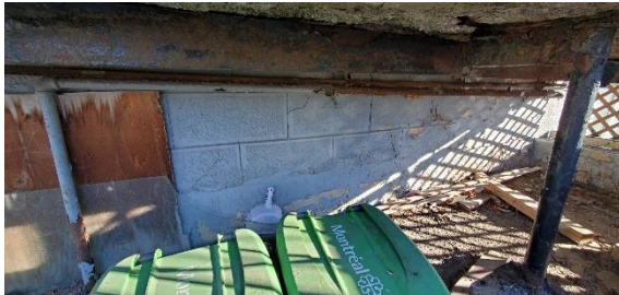
Photo 23- fissures bloc de béton
