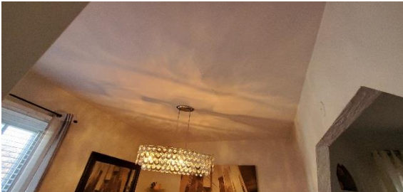
Photo 40 – Fissures et gonflement plafond 2 e étage
