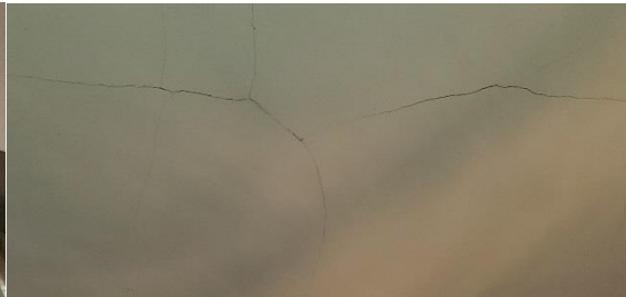
Photo 41 – Fissures et gonflement plafond 2 e étage
