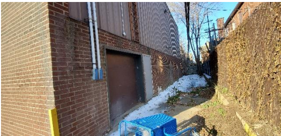
Photo 3- fissures revêtements briques
