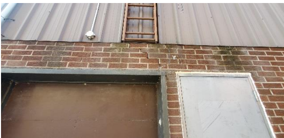
Photo 5- fissures revêtements briques
