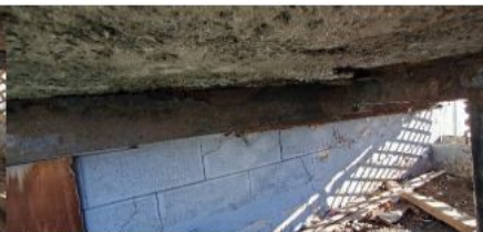
Photo 24- fissures bloc de béton
