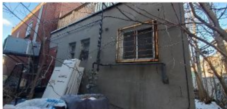
Photo 21- fissures bloc de béton
