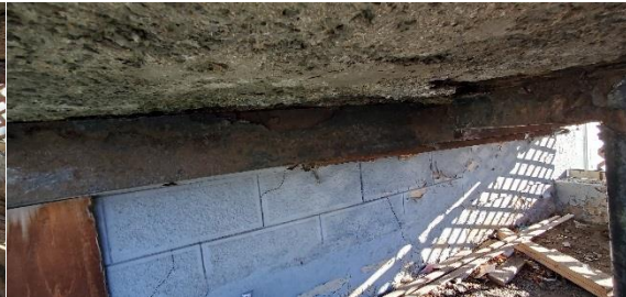
Photo 24- fissures bloc de béton
