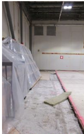
Photo 47 – Revêtement de plancher du gymnase Enlevé pour permettre pose des colonnes et contreventements
