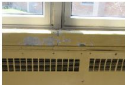
Photo 29 - Allège de fenêtre fissurée
