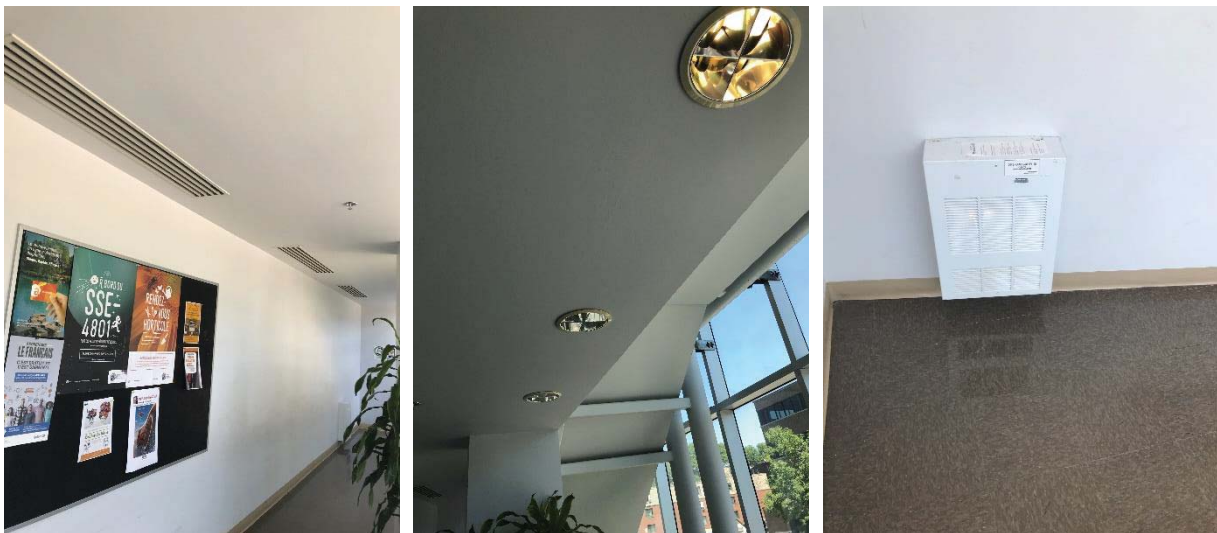
Figure 1 - Équipements mécaniques et électriques desservant l'escalier de secours
