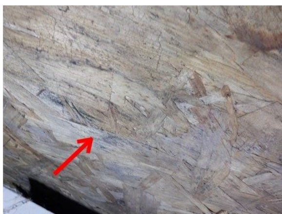
Exemple dans le vide sanitaire
