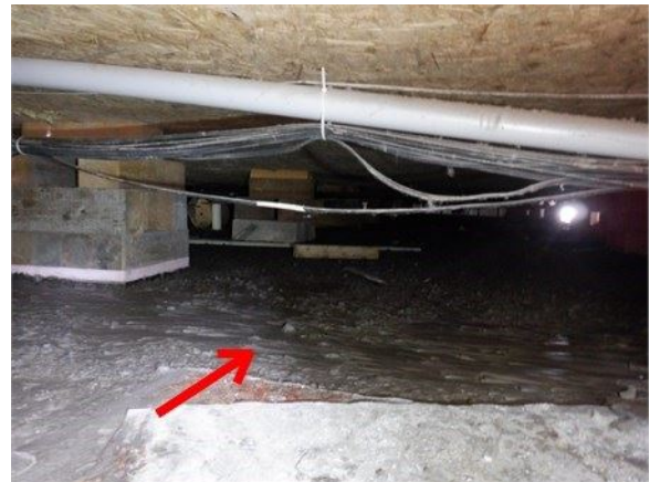
Exemple dans le vide sanitaire
