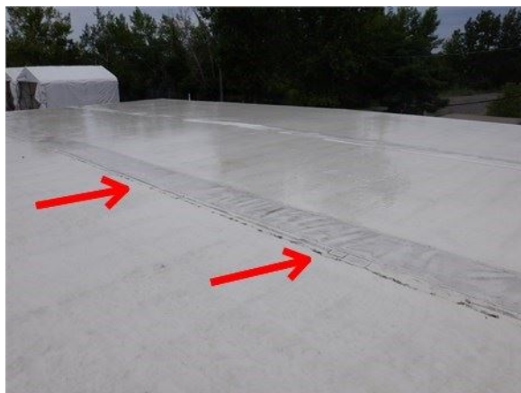
Exemple de détérioration
