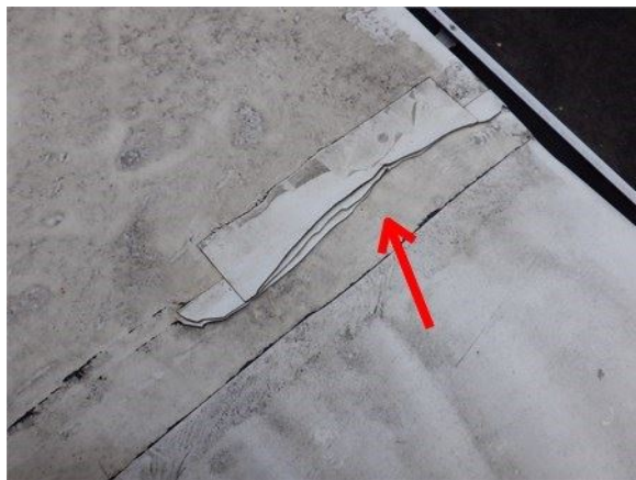
Exemple de détérioration
