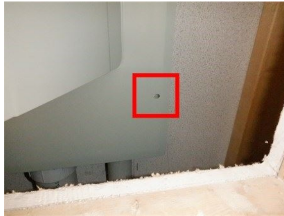
Sur le panneau électrique E
