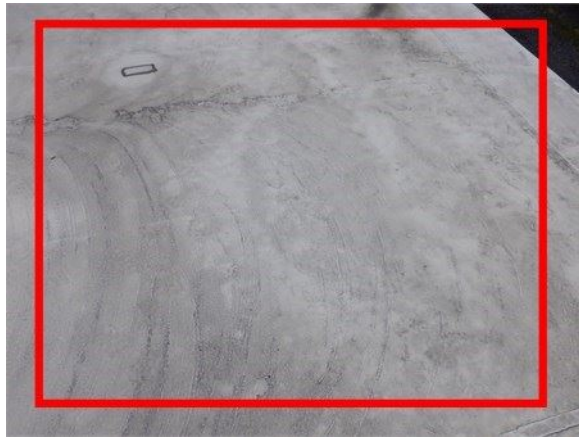
Toiture arrière - Exemple de point mou
