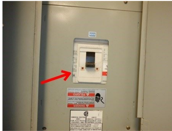
Sur un panneau électrique - Exemple
