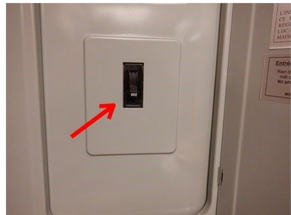
Sur le panneau électrique F
