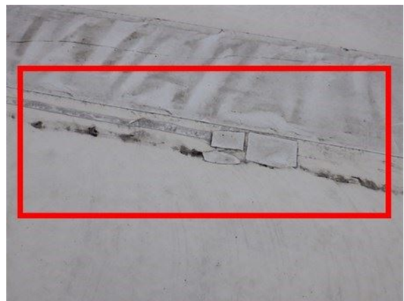
Exemple de détérioration
