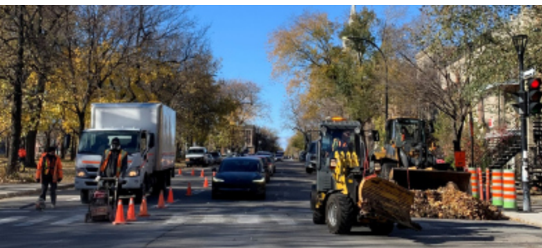
Maintien de la circulation et signalisation inadéquats.
