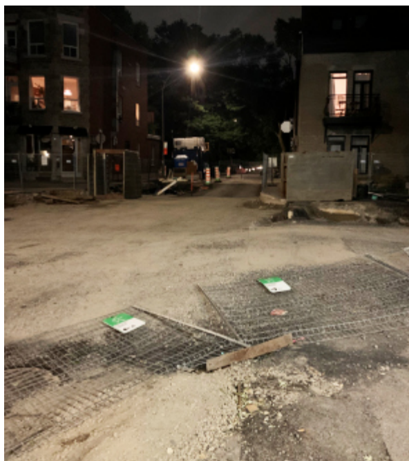
Clôtures tombées ou poussées au sol aux abords d'un chantier.
