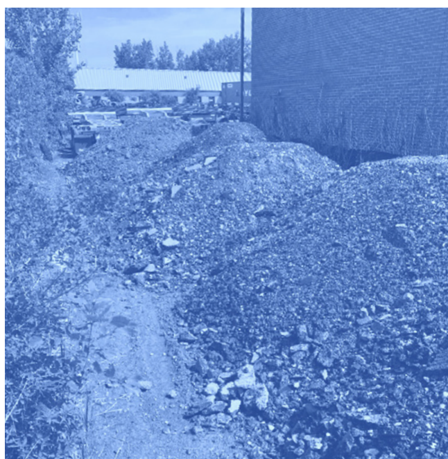
La gestion hors site des matières granulaires résiduelles telles que les résidus de planage ou de béton issus de la démolition des chaussées et des trottoirs n'est pas adéquatement contrôlée sur les chantiers de Montréal. Sur cette photo, des résidus de planage ont été éliminés sur un terrain privé. Crédit photo : BIG
