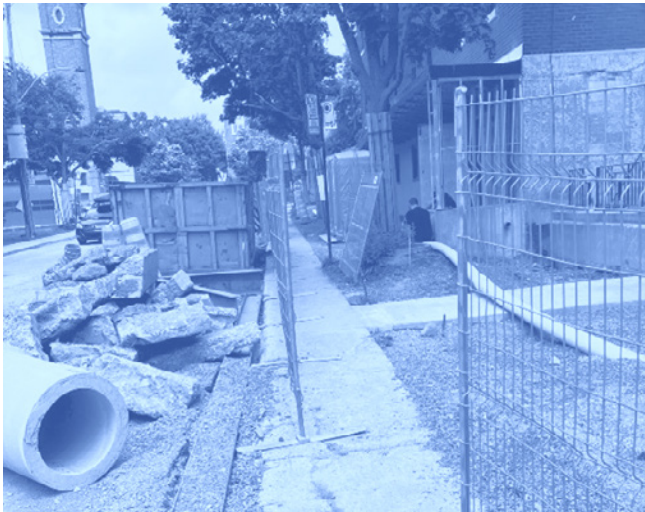
Des enquêteurs ont interpellé sur place les responsables des travaux en raison de déficiences flagrantes mettant à risque la sécurité des personnes qui circulaient aux abords des chantiers. Crédit photo : BIG
