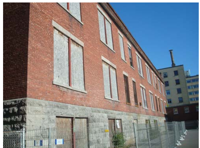
Certains linteaux de pierre peuvent être récupérés, certaines sections de maçonnerie portent à croire qu'un simple rejointoiement serait suffisant – L'état général de la maçonnerie demande d'importants travaux de restauration mais l'ensemble est tout à fait récupérable.
