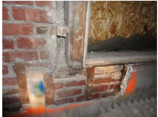
Vue d'un coin inférieur dégarni d'une fenêtre
