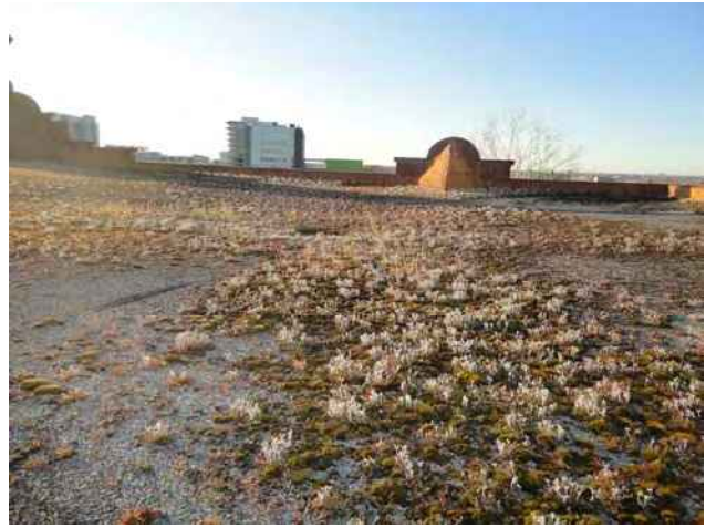
Vue d'ensemble du complexe d'étanchéité – au centre, un drain – à l'arrière plan, un parapet
