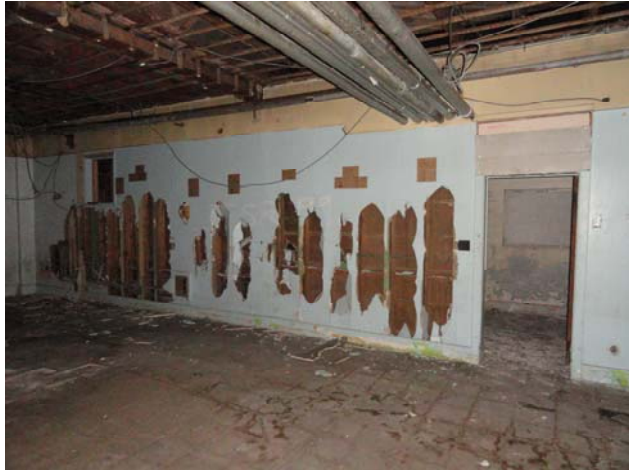
Cloison intérieure vandalisée
