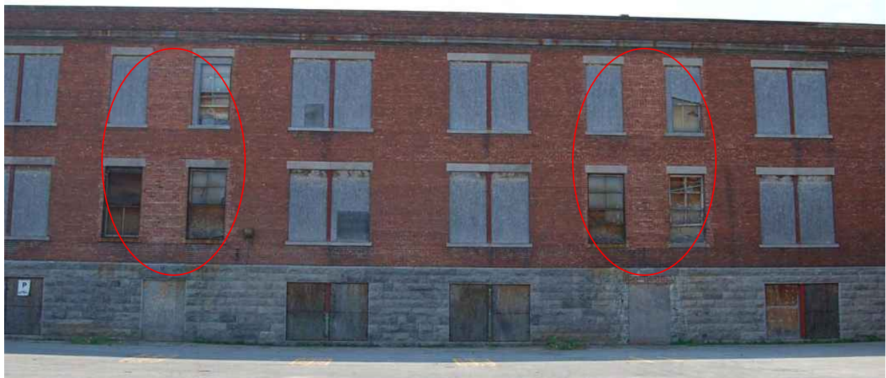
La couleur différente de la brique entre les baies laisse sous-entendre une reprise de la maçonnerie qui pourrait découler d'une modification des dimensions des ouvertures. Source : Mario Brodeur, juillet 2012.
