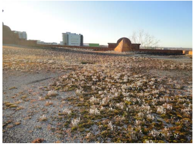
Vue d'ensemble du complexe d'étanchéité – au centre, un drain – à l'arrière plan, un parapet
