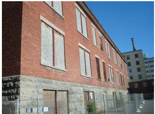
Certains linteaux de pierre peuvent être récupérés, certaines sections de maçonnerie portent à croire qu'un simple rejointoiement serait suffisant – L'état général de la maçonnerie demande d'importants travaux de restauration mais l'ensemble est tout à fait récupérable.
