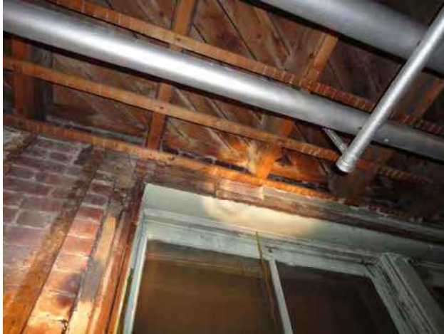
Côté intérieur d'une fenêtre dont la périphérie a été dégarnie. À partir du haut, on voit le pontage de bois, les solives encastrés dans la maçonnerie et le linteau de bois. À gauche, on aperçoit le cadre, le sous-cadre et la face intérieure du mur massif de maçonnerie. Une fourrure verticale servant à fixer le lattis de bois est encore présente
