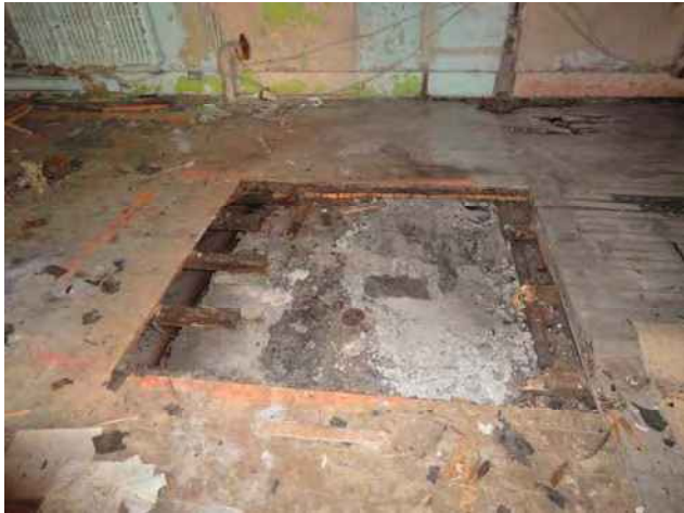
Dalle de béton dégarnie par notre entrepreneur général. On note, à la droite de l'image, l'arrêt de la dalle et le passage de tuyaux
