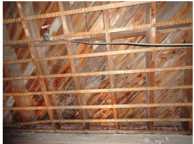
Exemple de pontage de bois en mauvais état – on remarque que l'extrémité des solives s'encastant dans les murs extérieurs est affectée par les infiltrations d'eau ;
