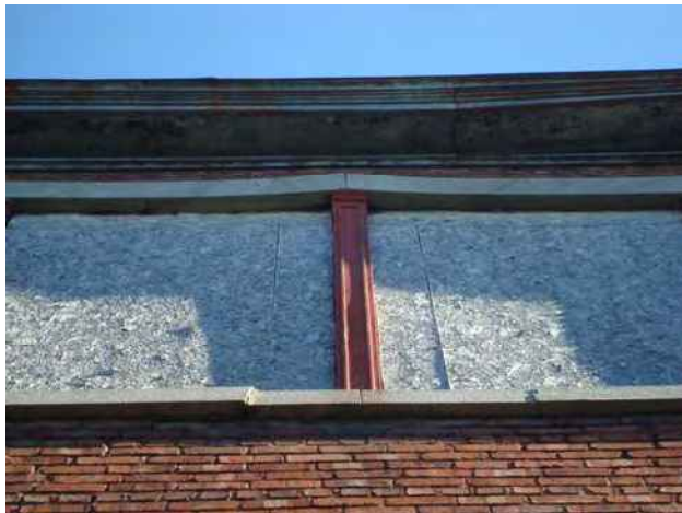
Exemple de linteau et allège de pierre calcaire à remplacer – le support central en fonte peinte est généralement en bon état
