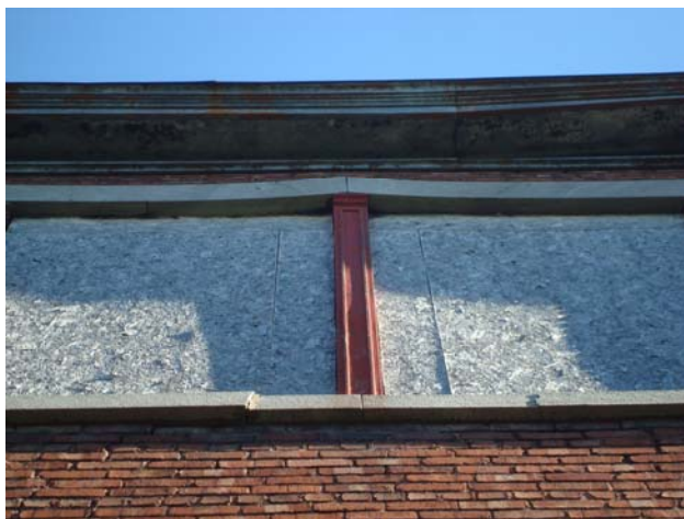
Exemple de linteau et allège de pierre calcaire à remplacer – le support central en fonte peinte est généralement en bon état
