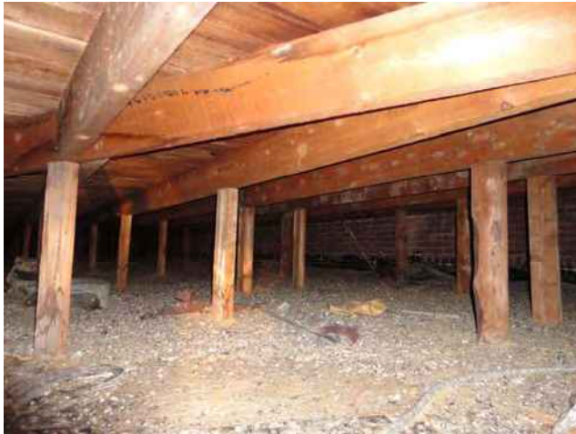
Entre-toit – l'isolant est couvert de fientes de pigeons – la base des poteaux est affectée par l'eau – les éléments de charpente principale sont en bon état mais on y note des taches dues à l'eau
