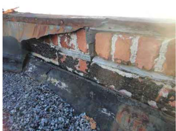
Détail de parapet démontrant une dégradation avancée du système laissant place à d'importantes infiltrations d'eau ;
