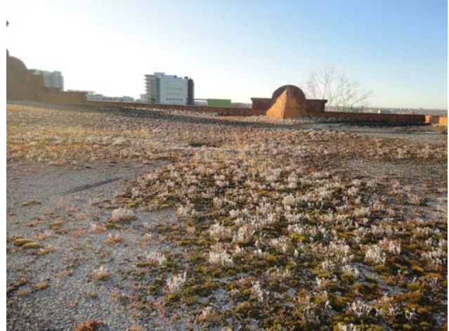
Vue d'ensemble du complexe d'étanchéité – au centre, un drain – à l'arrière plan, un parapet
