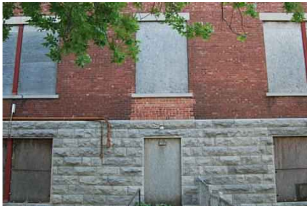
Transformation d'une porte en fenêtre à la façade est ? Source : Mario Brodeur, juillet 2012.
