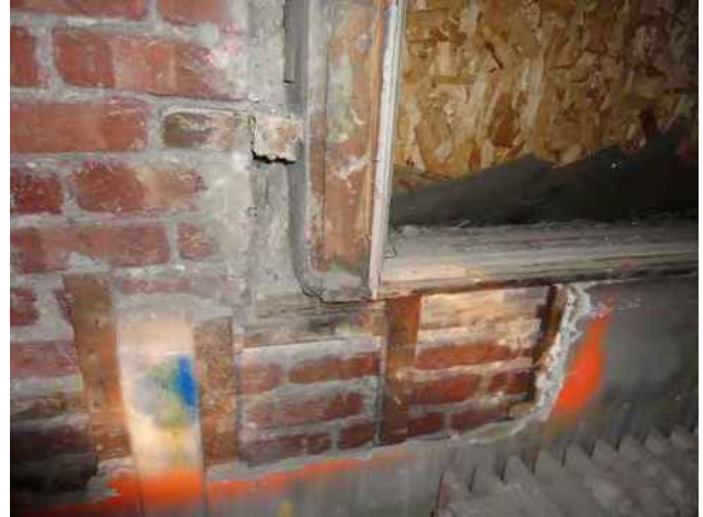
Vue d'un coin inférieur dégarni d'une fenêtre
