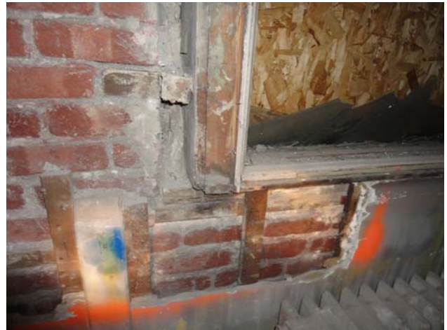
Vue d'un coin inférieur dégarni d'une fenêtre
