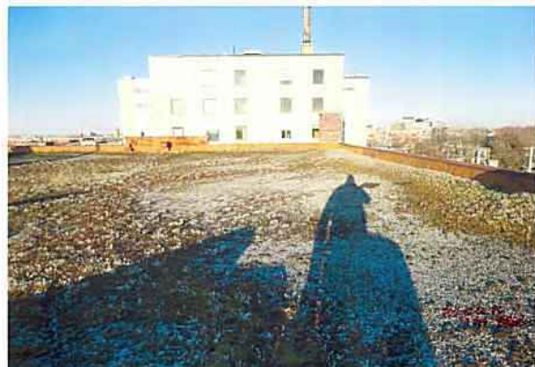
Couverture multicouche en voie de devenir un toit vert... Source : BBBL architectes, 2012.
