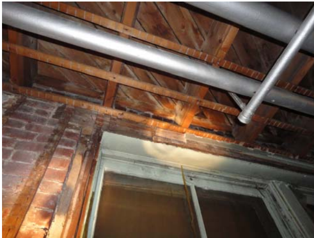
Côté intérieur d'une fenêtre dont la périphérie a été dégarnie. À partir du haut, on voit le pontage de bois, les solives encastrés dans la maçonnerie et le linteau de bois. À gauche, on aperçoit le cadre, le sous-cadre et la face intérieure du mur massif de maçonnerie. Une fourrure verticale servant à fixer le lattis de bois est encore présente
