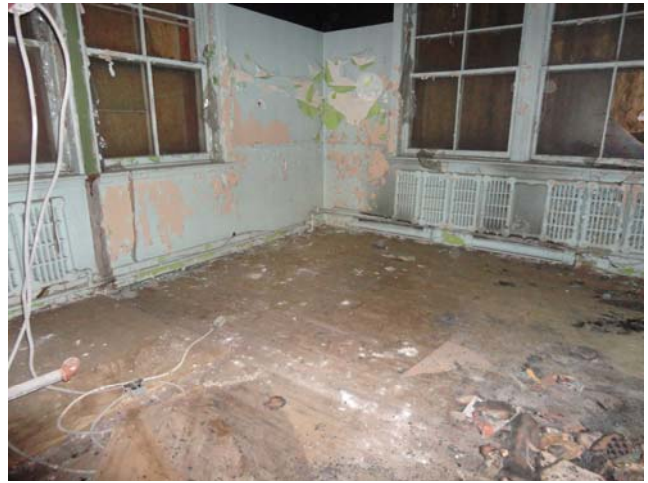
Vue intérieure d'un mur extérieur, au sous-sol – à droite, traces de début d'incendie ;
