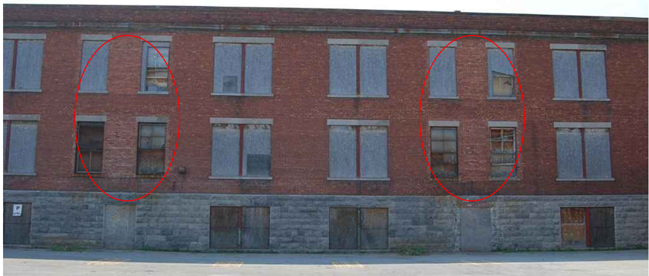
La couleur différente de la brique entre les baies laisse sous-entendre une reprise de la maçonnerie qui pourrait découler d'une modification des dimensions des ouvertures. Source : Mario Brodeur, juillet 2012.
