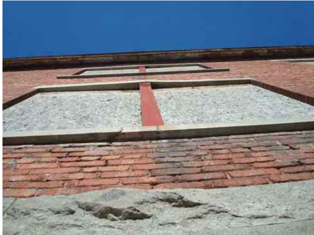
Vue vers le haut près du mur - linteau et allège de pierre calcaire à remplacer – le support central en fonte peinte est généralement en bon état
