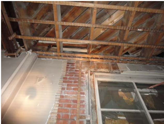
Vue intérieure d'un mur extérieur – fenêtre, maçonnerie et lattis de bois avec enduit cimentaire – la maçonnerie intérieure est dans un état stable et sa réparation est possible ;
