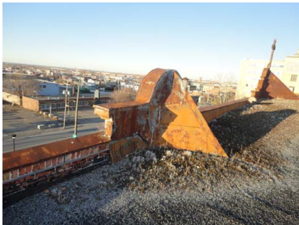
Parapet recouvert de tôle en acier galvanisé peint – L'état de la maçonnerie constituant ces éléments rend leur récupération impossible – à gauche, la tôle devant remonter sur la maçonnerie est absente
