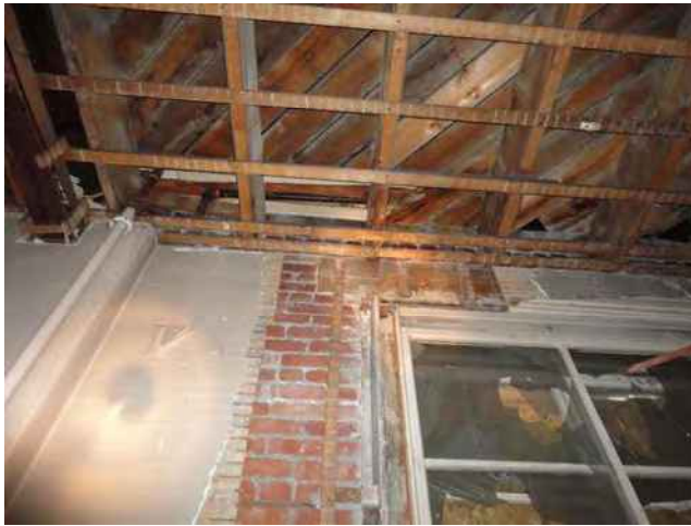
Vue intérieure d'un mur extérieur – fenêtre, maçonnerie et lattis de bois avec enduit cimentaire – la maçonnerie intérieure est dans un état stable et sa réfection est possible ;
