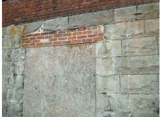
Travaux de fermeture du mur extérieur. La dégradation du mur de pierre autour est importante.
