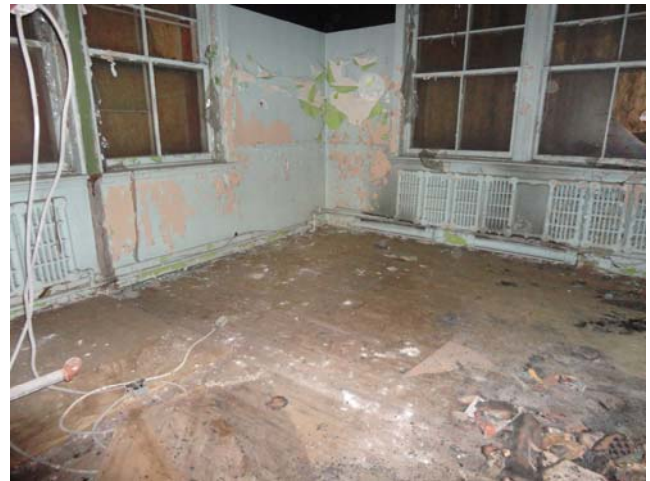
Vue intérieure d'un mur extérieur, au sous-sol – à droite, traces de début d'incendie ;
