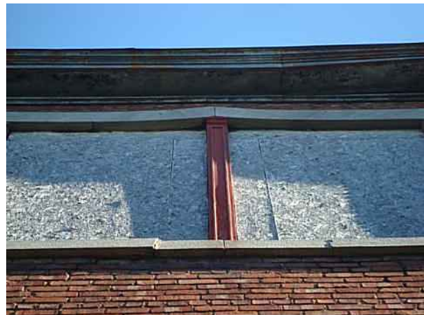
Problèmes d'allège et de linteau. Source : BBBL architectes, 2012.
