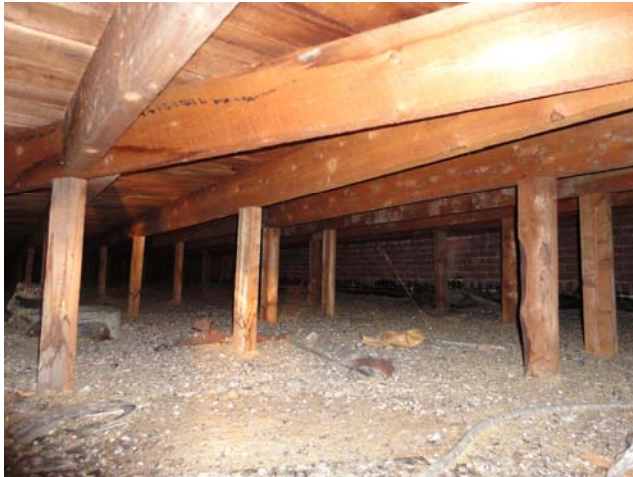
Entre-toit – l'isolant est couvert de fientes de pigeons – la base des poteaux est affectée par l'eau – les éléments de charpente principale sont en bon état mais on y note des taches dues à l'eau
