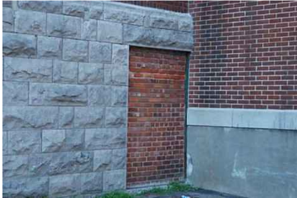
Obturation de la baie au niveau du sous-sol pour le raccord du passage couvert. Source : Mario Brodeur, juillet 2012.
