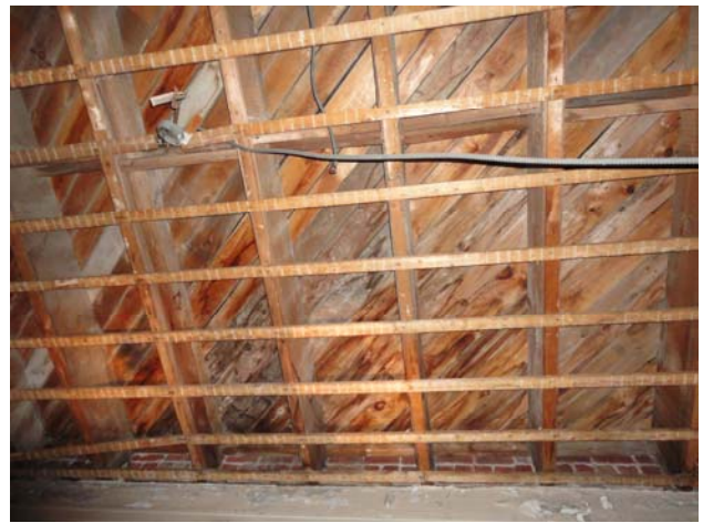
Exemple de pontage de bois en mauvais état – on remarque que l'extrémité des solives s'encastrant dans les murs extérieurs est affectée par les infiltrations d'eau ;
