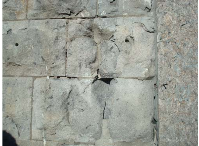
Maçonnerie de blocs de pierre fissurés à remplacer
