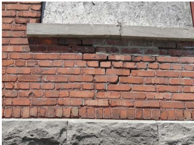
Exemple d'une partie de mur dont au moins les deux premières épaisseurs du mur massif de brique sont à enlever et reconstruire ;
