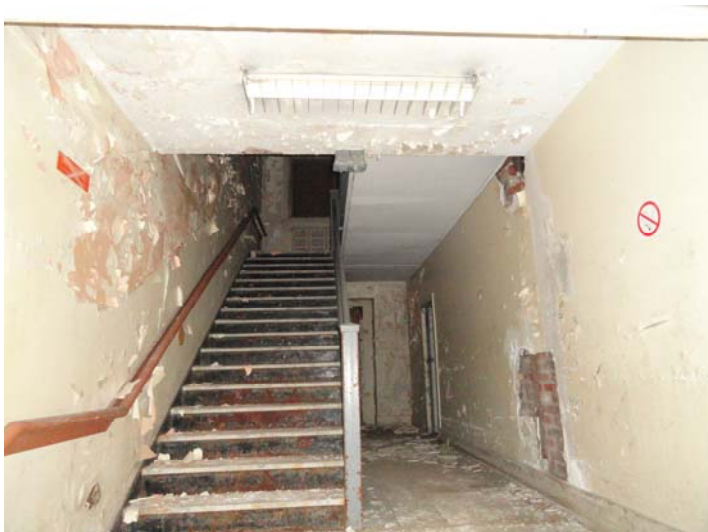
Escalier nord – l'ossature de l'escalier est saine et peut être récupérée – à droite, la cloison séparant l'escalier de la salle mécanique.
