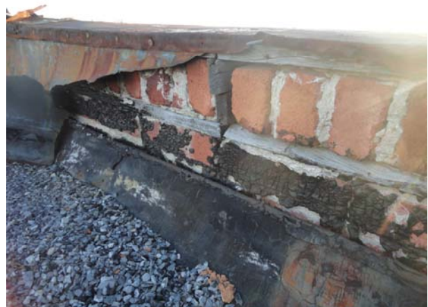
Détail de parapet démontrant une dégradation avancée du système laissant place à d'importantes infiltrations d'eau ;
