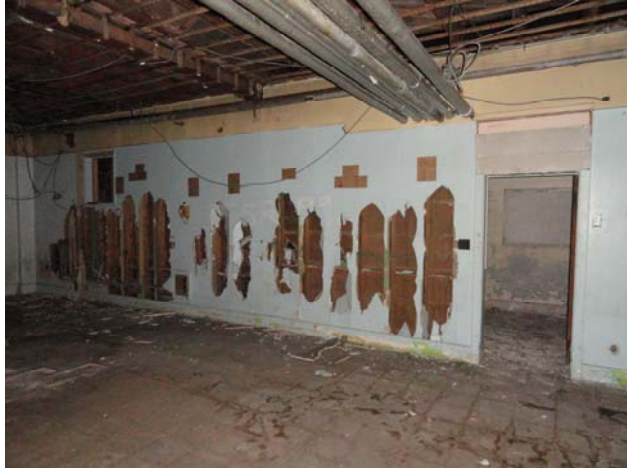
Cloison intérieure vandalisée
