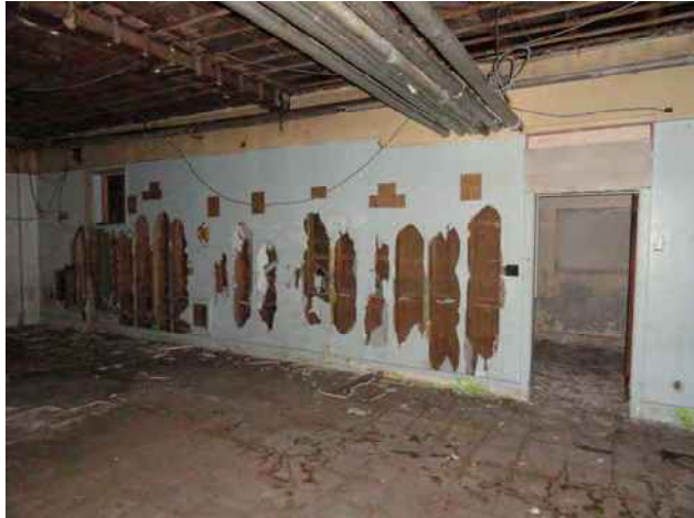
Cloison intérieure vandalisée
