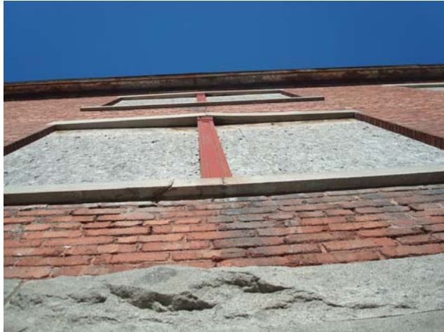
Vue vers le haut près du mur - linteau et allège de pierre calcaire à remplacer – le support central en fonte peinte est généralement en bon état
