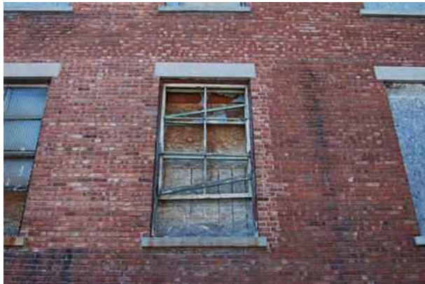
État généralisé des fenêtres originales. Source : Mario Brodeur, juin 2012.
