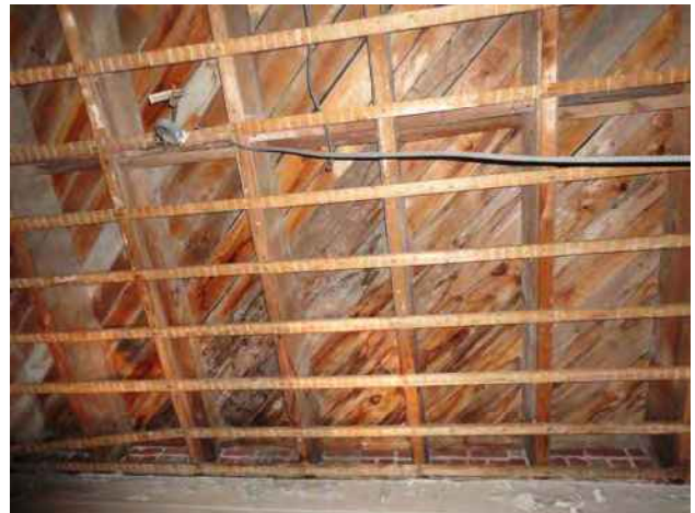
Exemple de pontage de bois en mauvais état – on remarque que l'extrémité des solives s'encastrent dans les murs extérieurs est affectée par les infiltrations d'eau ;
