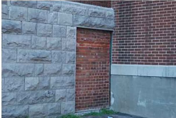
Obturation de la baie au niveau du sous-sol pour le raccord du passage couvert. Source : Mario Brodeur, juillet 2012.
