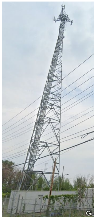
Antennes et télécommunication
