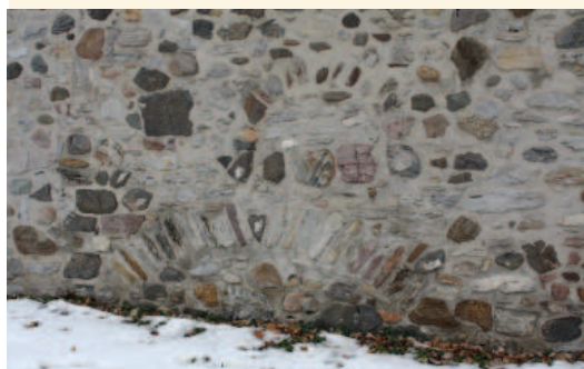
L'arc de décharge du foyer et la lumière du four perceptibles dans le pignon est Photo : Ville de Montréal, 2019
