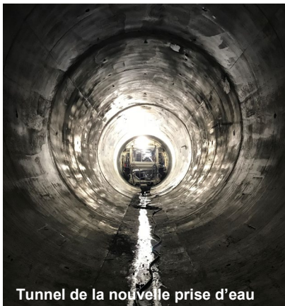
Service de l'eau de la Ville de Montréal
