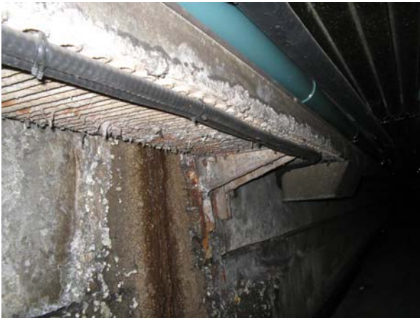
Infiltration dans chemin de câbles sous la pierre de quais
