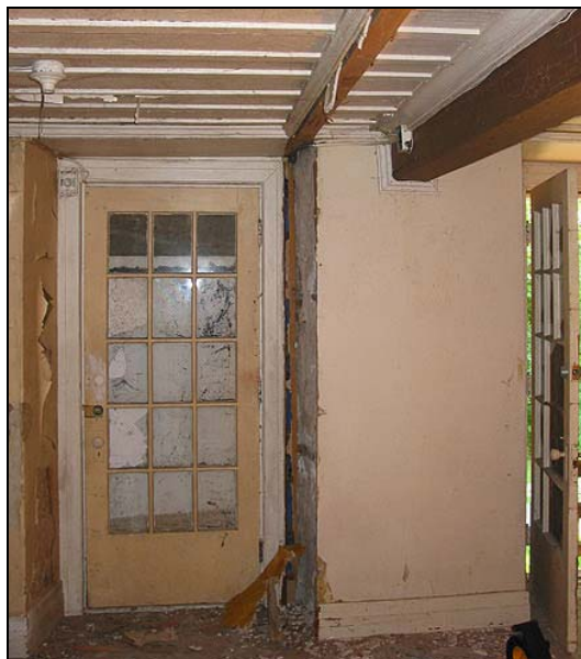
Figure 2.36. Entrée est et traces de la cloison de division entre les deux côtés du rez-de-chaussée, maison Richer dit Louveteau, 2007
