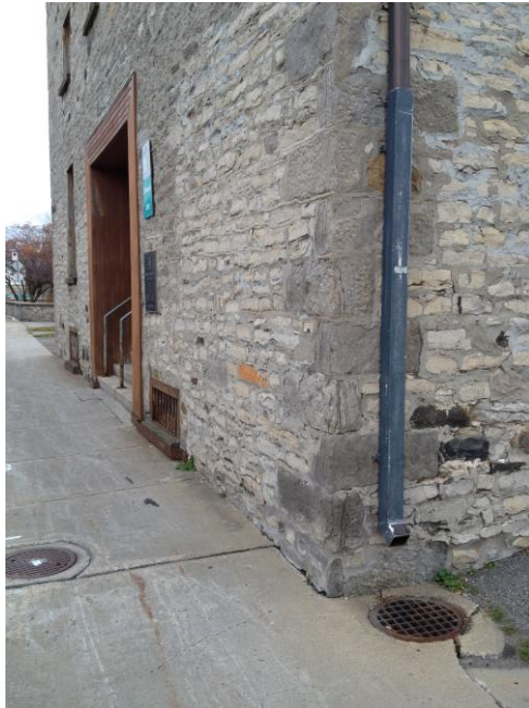
Exemple de bâtiment municipal avec une gouttière non dirigée vers une surface perméable
