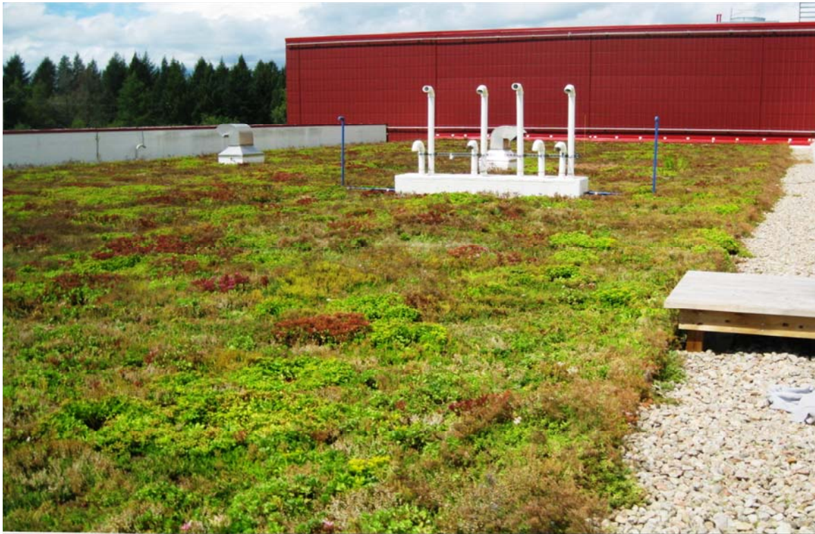
CENTRE DE DISTRIBUTION SOBEYS TROIS-RIVIÈRES 10,000 pi 2 2007 SYSTÈME XF300 + 15cm XEROTERR 50 lb/pi 2 GROSS KAPLIN COVIENSKY ARCHITECTES/ BLOUIN TARDIF ARCHITECTURE Xeroflor 6
