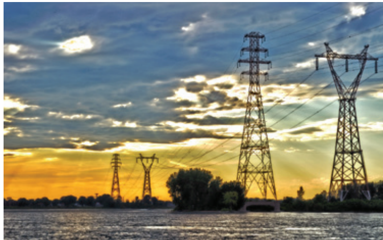
Lignes aériennes de transport d'énergie électrique
