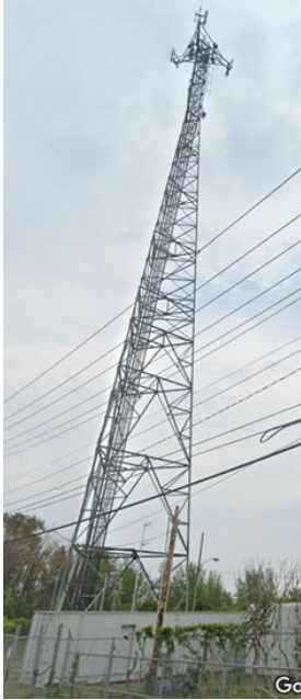
Antennes et télécommunications
