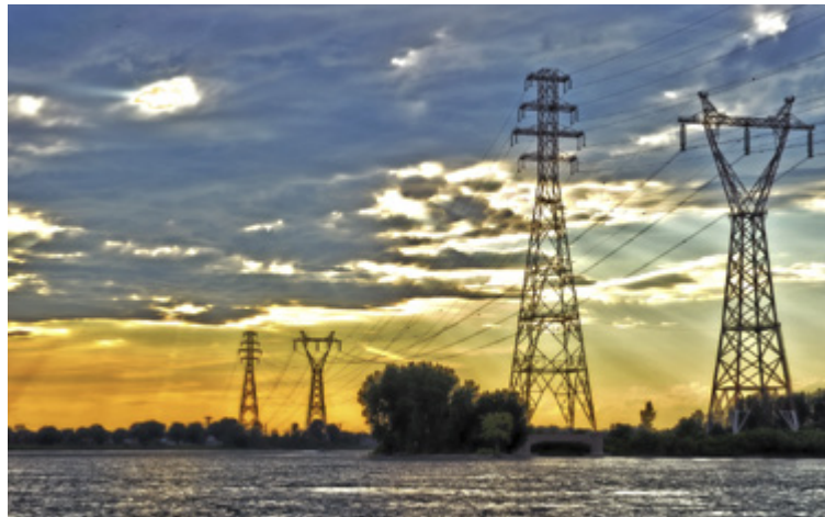
Lignes aériennes de transport d'énergie électrique
