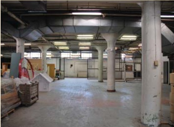
Structure en béton du bâtiment 1, composée de colonnes à chapiteau conique ( mushroom ) (source : Ville de Montréal, avril 2016).
