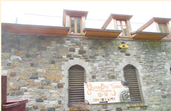
La chaufferie lors de son usage par la Maison des jeunes Source : Passerelles coopérative en patrimoine
