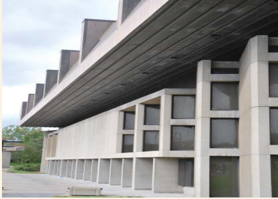
L'imposante toiture repose sur un bandeau de verre qui surmonte le mur extérieur très articulé.
