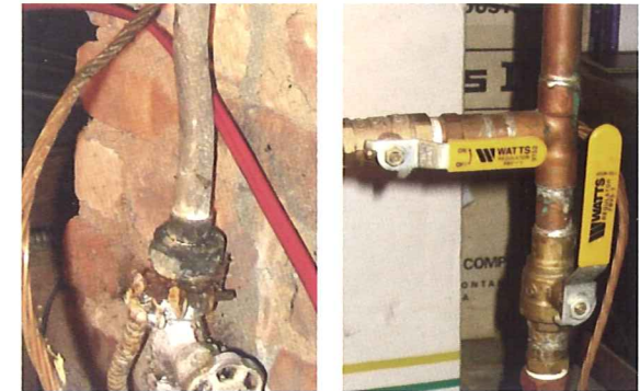
Exemple d'un tuyau en plomb
