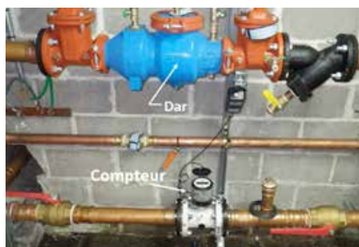
Exemple d'un compteur installé avec un dispositif anti-retour
