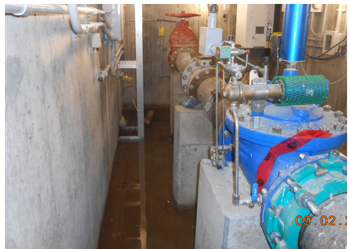
Exemple de nouvelle chambre de régulation de pression
